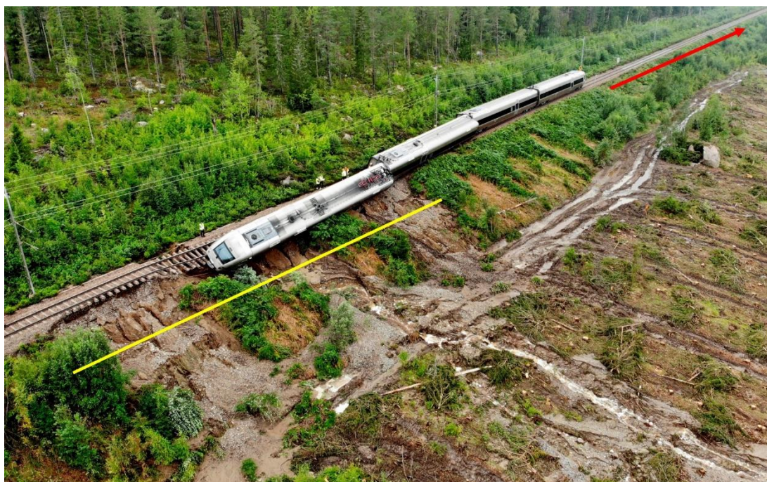
Figur 1. Bild som visar olycksområdet. Vatten har runnit genom banvallen och fört med sig material från banvallen till nedströms liggande mark. Markeringar inlagda av SHK. Den gula markeringen visar rasområdet och den röda pilen visar tågets färdriktning. Foto: Mats Andersson.
