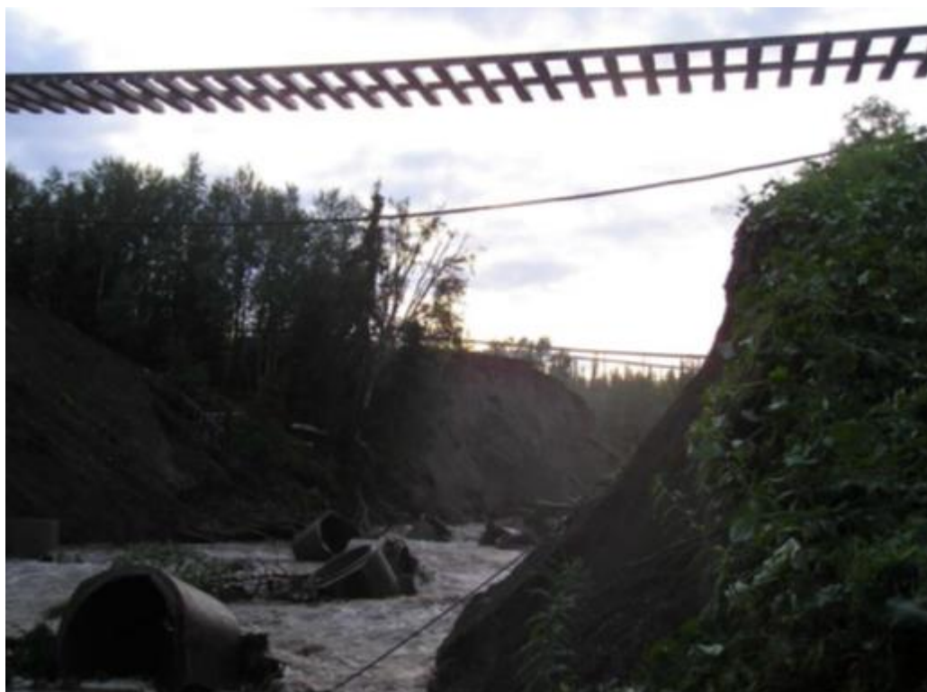
Figur 22. Bild från Banverkets utredning av urspårningen i Are. I förgrunden räl i luften över en bortspolad banvall. I bakgrunden vägräcken i luften över en bortspolad vägbank. Källa: Banverket
