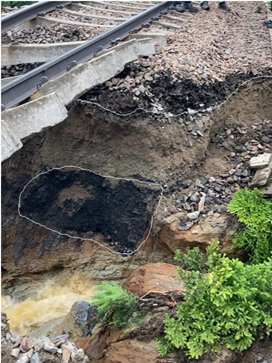
Figur 6. Bilden visar bankroppen strax efter urspårningen. På bilden ses ett lager av makadam, ungefär 300 mm (i jämförelse är en sliper 185–190 mm tjock/hög). Lagret under makadammen är silt, finsandigt material och därunder ett fastare lager av morän. Det svarta lagret består troligen av kolstybb som fyllts ut när banvallen byggdes, se markering.
