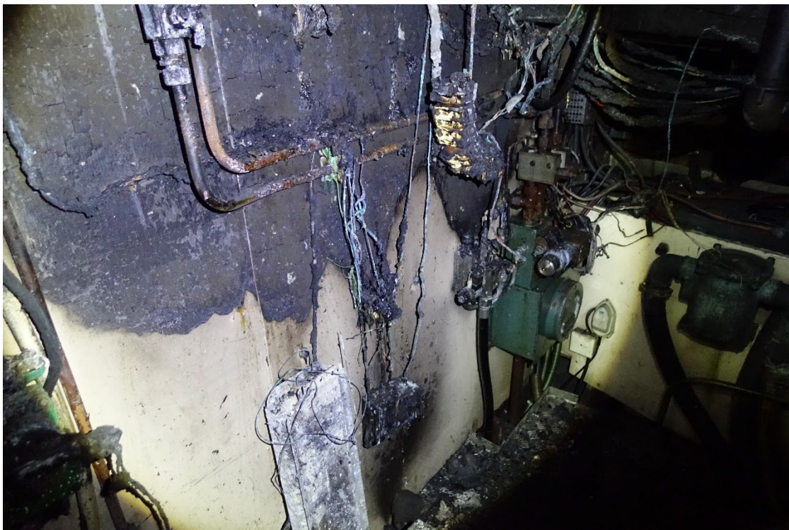
Foto 3. Främre maskinrums skottet med 24 volts säkringspanelen
