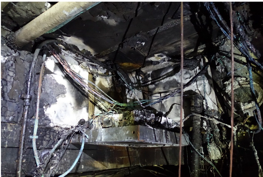
Foto 4. Hyllan för startbatterierna samt batteriladdare
