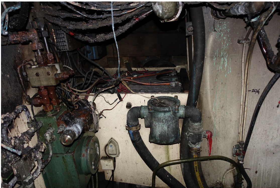
Foto 5. Förbrukningsbatterierna är oskadade
