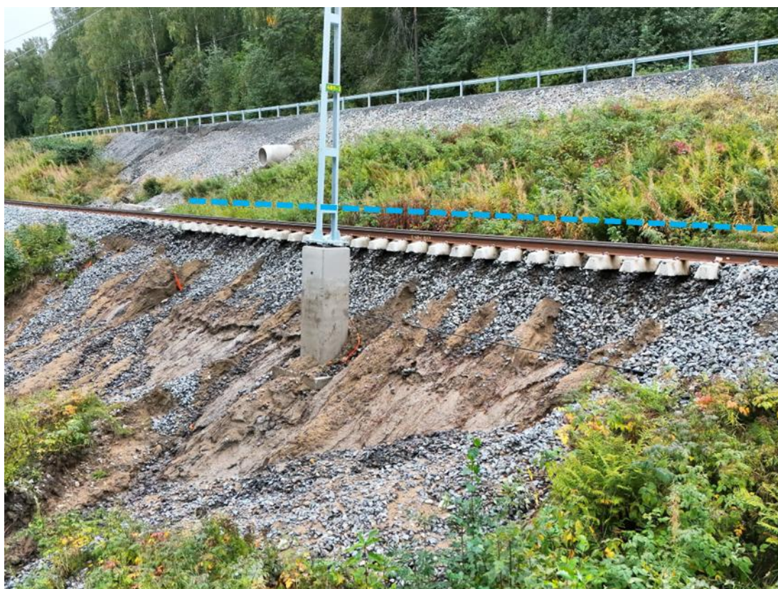
Figur 13. Bilden visar en skada på banvallen drygt 500 meter norr om urspårningsplatsen. Stora mängder vatten i diket mellan vägen och järnvägen (markerat med blått streck) spolade genom banvallen och orsakade erosion på den motsatta sidan. Foto: Trafikverket.
