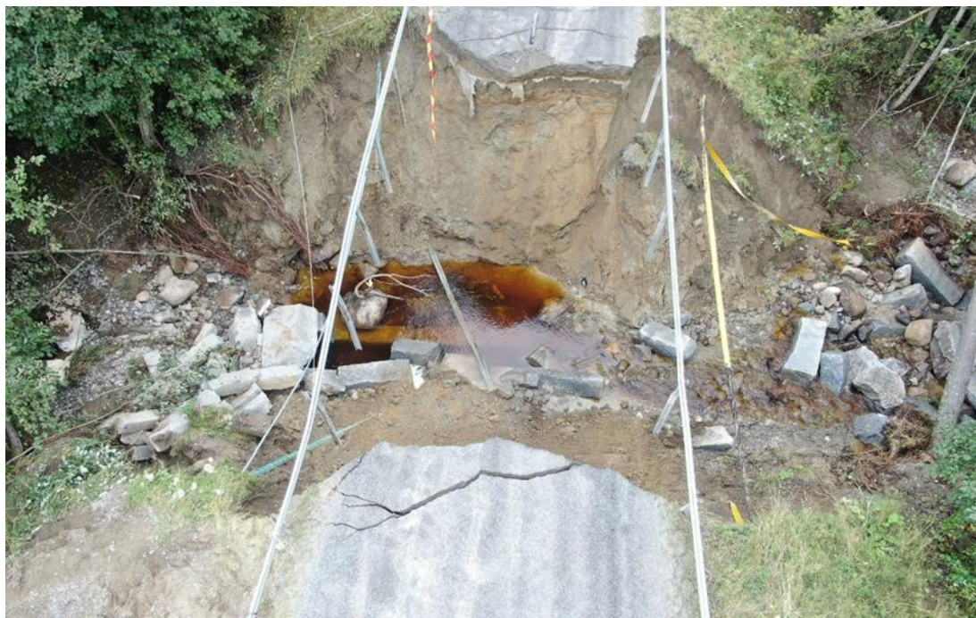
Figur 14. Skador på väganläggningen. De rektangulärt formade stenarna hade använts som byggelement till stentrumman. Foto: Trafikverket.
