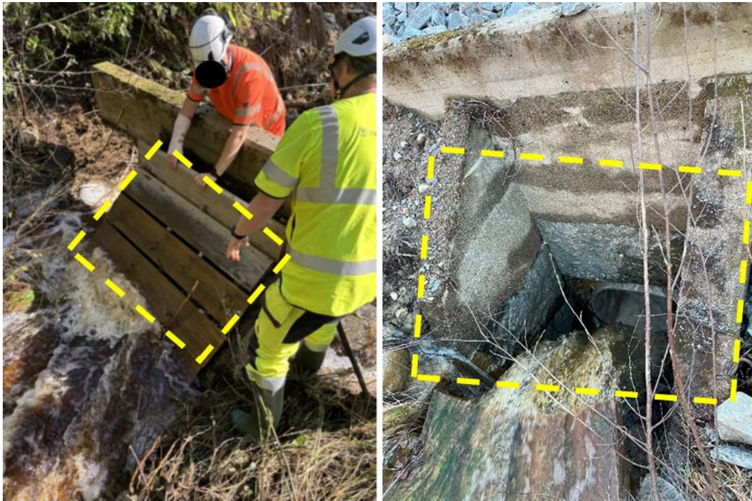
Figur 10. Locket över brunnen som kraftigt reducerade kapaciteten att leda vatten ner till trumman under järnvägen. Till höger visas brunnen utan lock. Gula markeringar införda av SHK för att visa var locket var placerat. Foto: Trafikverket.
