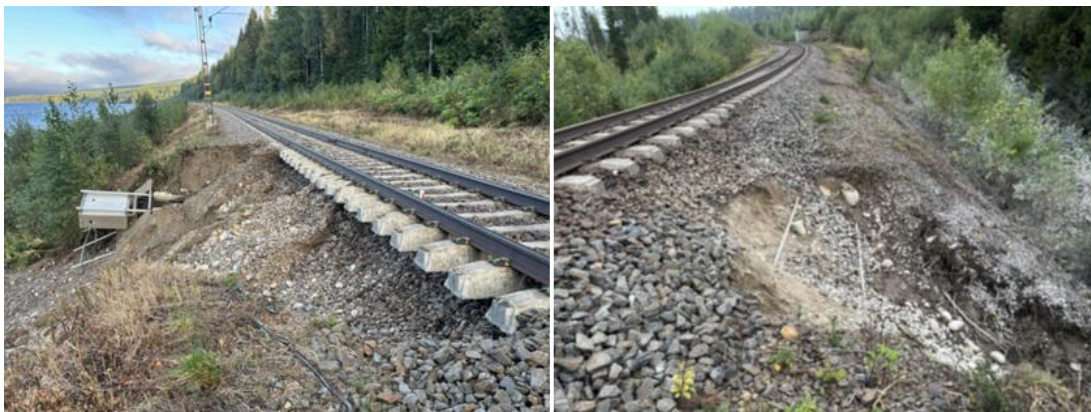
Figur 8. Exempel på andra skador på banvallen vid järnvägens längdmätning km 700 och 713. Foto: Trafikverket.
