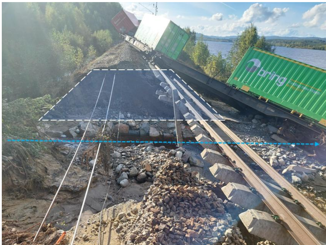
Figur 6. Urspårningsplatsen med den skadade banvallen och den fjärde vagnen urspårad ner mot sjön. Vatten hade fördämts upp mot spåret på bildens vänstra sida. Banvallen bestod till stor del av finkorning siltjord och grus, markerat i det grå, streckade området. Den blå linjen visar var stentrumman gick från kassunen till vänster, ut till Stugusjön på höger sida. Foto: Trafikverket.
