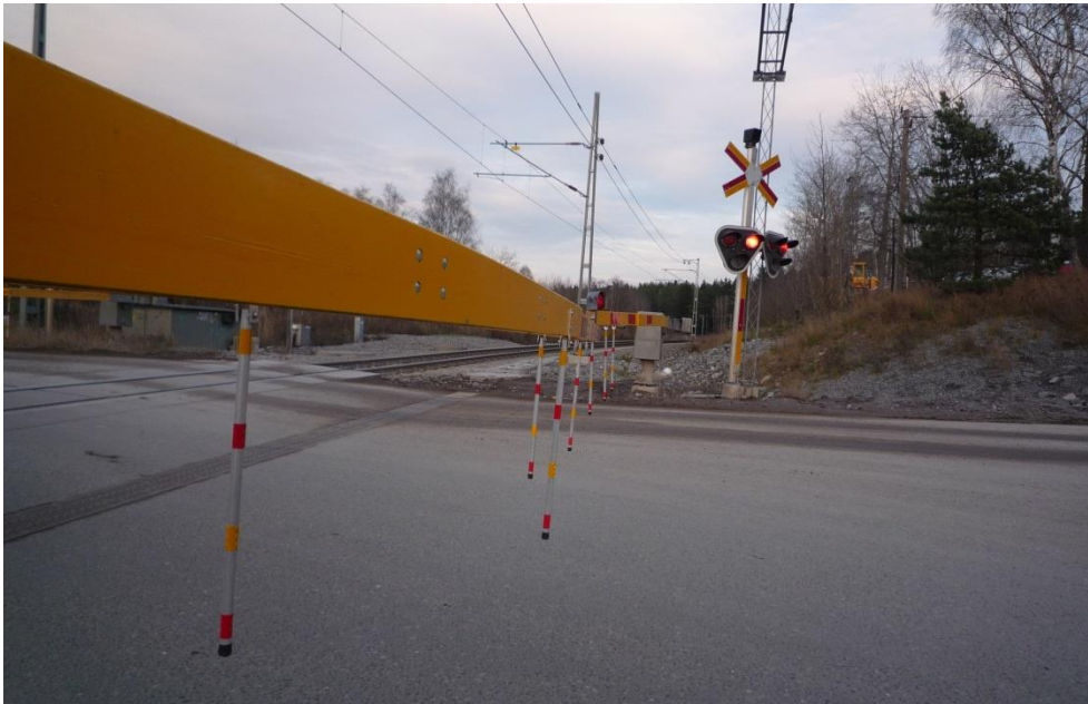
Figur 12. Spröt som har monterats på bommarna i aktuell plankorsning, vilka förhindrar att de når fullt nedfällt läge om det finns hinder under bommarna. Foto: SHK.
