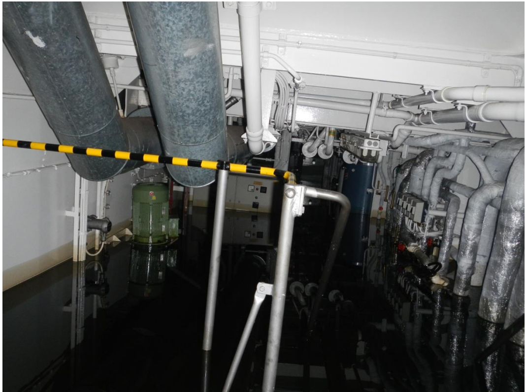
Bild 2. Maskinrummet efter vatteninträngning.
