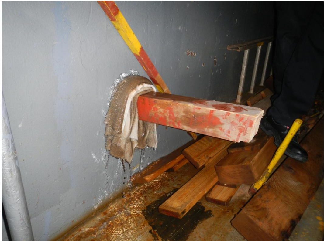
Bild 6. Försök att stoppa vattenflödet i genomföringen från maskinrummet. Bilden tagen från lastrummet.
