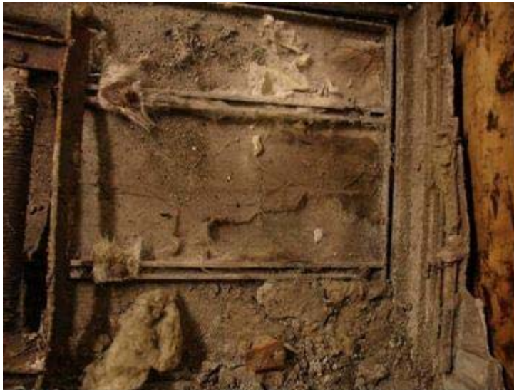
Fig. 9 Foto på locket från den skadade AL1.
