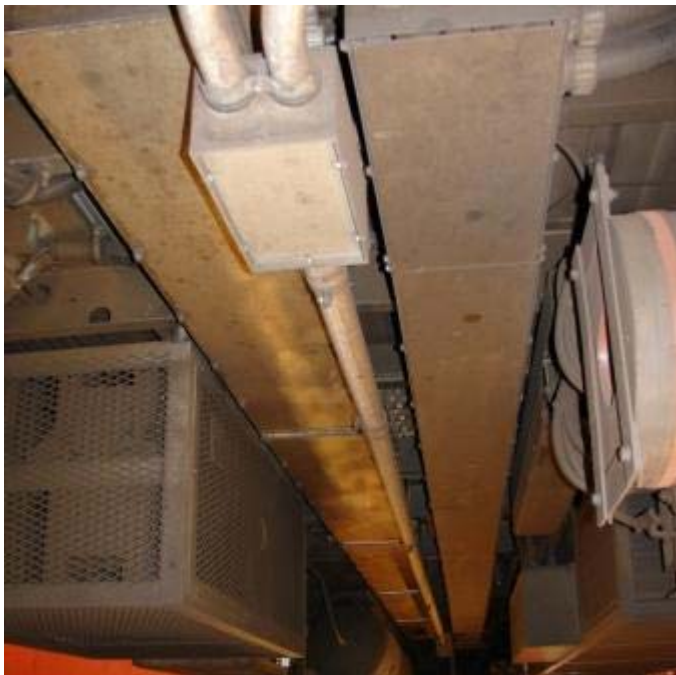
Fig. 15 Kabelkanaler i underredet.
