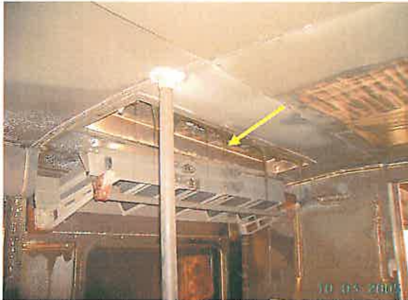
Figur 4 Bilden visar hur armarplasten hängde som lakrits (se gul pil) längre bort från branden. Försök i värmeskåp visar att plasten börjar deformeras kraftigt vid ungefär 180 °C.
