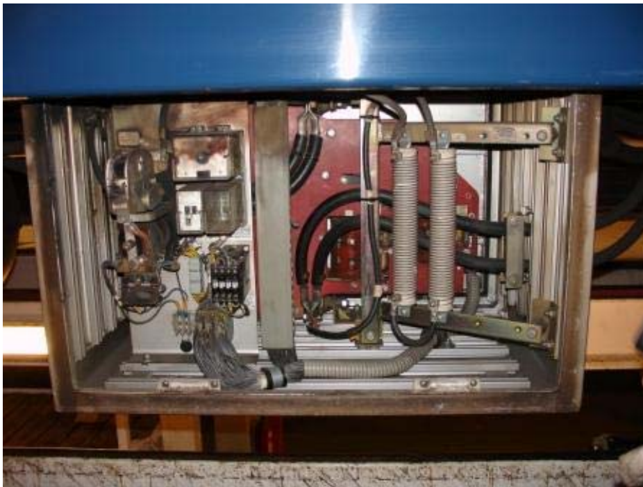
Fig. 17 AL1 sedd från vagnssidan med luckan borttagen. Linjekondensatorkontakter till vänster och uppladdningsmotstånd till höger.
