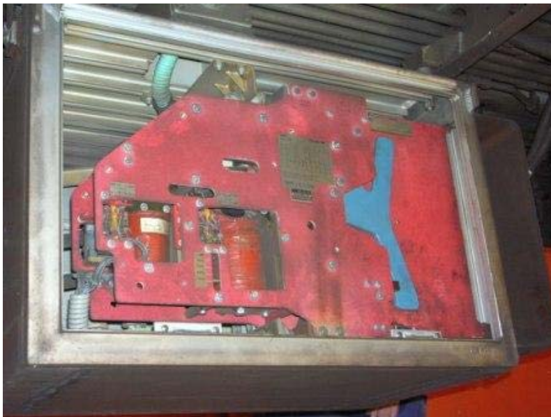
Fig. 18 Linjebrytaren i AL1, sedd från vagnsmitt med lucka borttagen.
