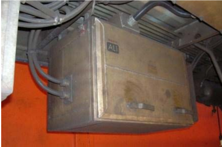
Fig. 16 Linjebrytarlåda AL1 sedd från vagnsmitt.
