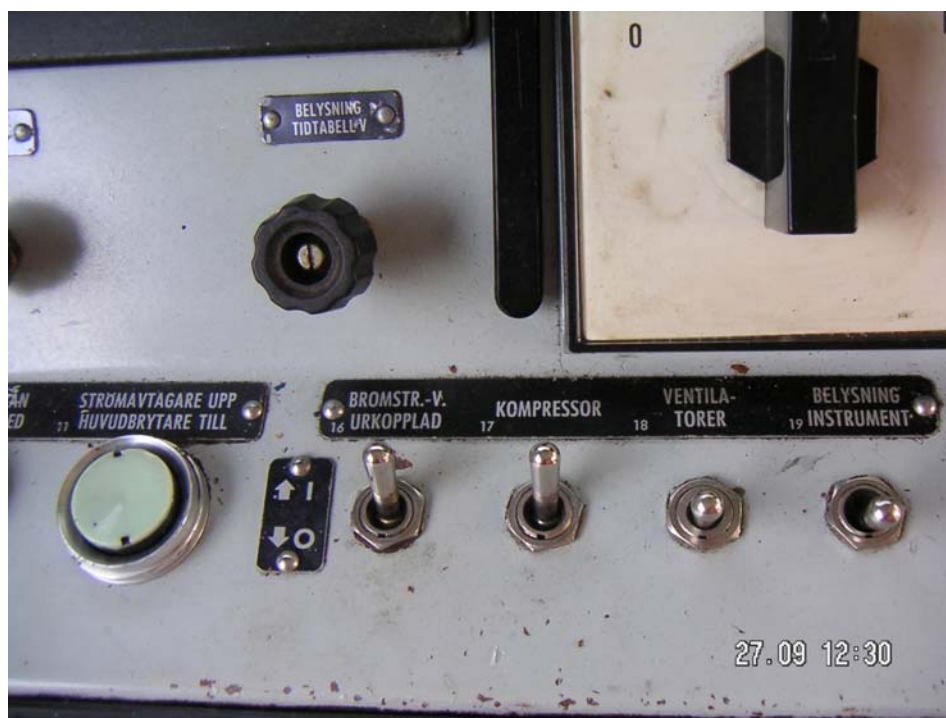
Fig. 5: Strömställarna på förarplatsen som var vänt framåt i det lok som rullade mot de andra loken (1094). Bromstryckvakten är urkopplad (strömställaren längst till vänster) och kompressorn är till (nästa strömställare). Strömställaren för ventilatorer är ersatt av strömställaren i fig. 5.
