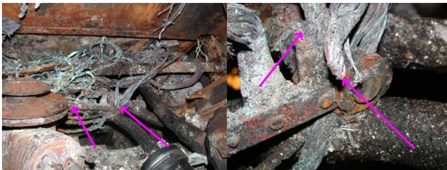
Fig. 5a-b B+skena och kabel. Pilarna visar spår efter en kraftig ljusbåge.
