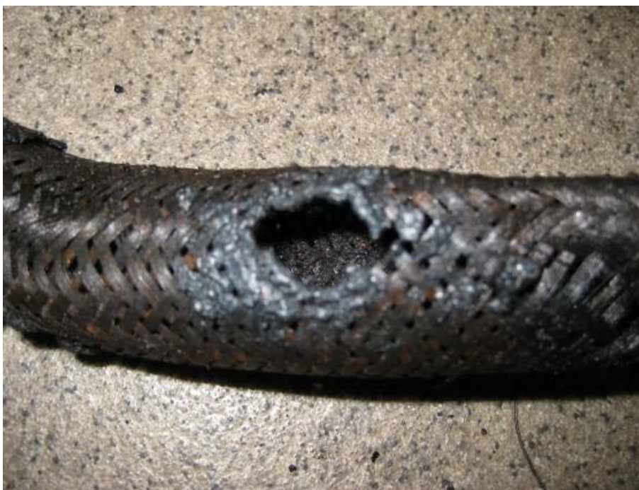
Fig. 14 Kortslutning mellan elkabel och metallflätad hydraulslang.
