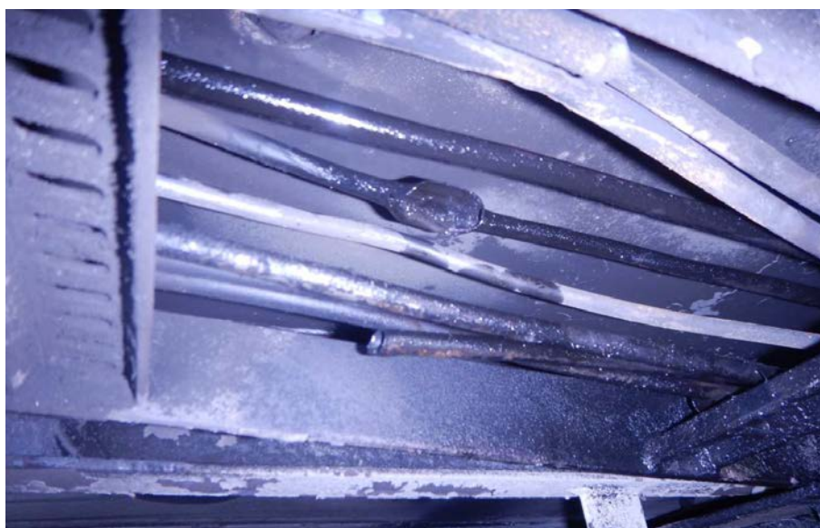
Figur 28. Rörledning för hydraulolja och kabeldragningar ovanför bilarna, som påverkats av branden.
