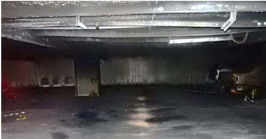
Figur 3. Undersidan av däck 2 ovanför där bilarna som brunnit har stått. Däcksplåten och balkarna har deformerats både uppåt och nedåt.
