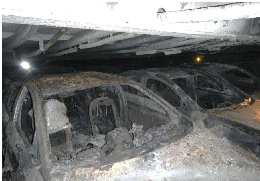
Figur 13. Brandskadad bil på däck 1. Observera nedbuktningen på däck 1 ovanför.
