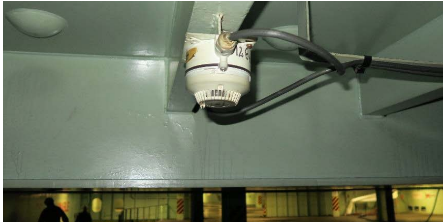
Figur 5. Rökdetektor i lastrummet.
