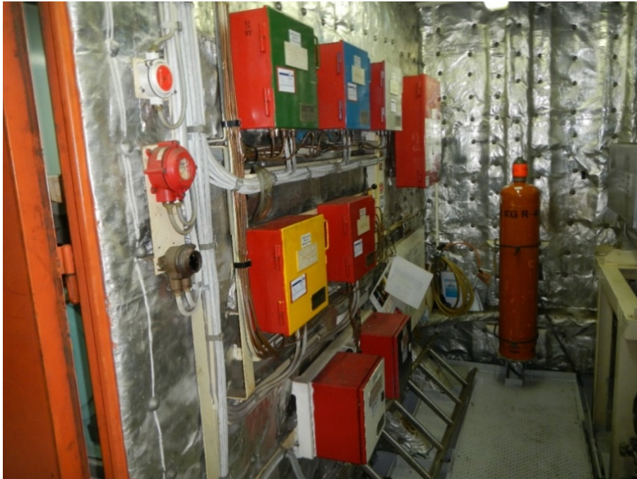
Figur 7. "CO 2 -rummets" manöverskåp, vilket användes för att starta släckanläggningen.
