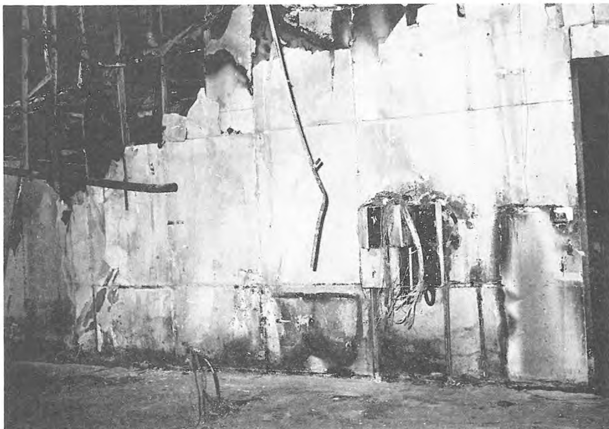
Figur 2 Efter uppröjning. Till vänster syns en del av den triangulära skadan på väggen. Till höger den plats där varmvattenberedaren stått.
