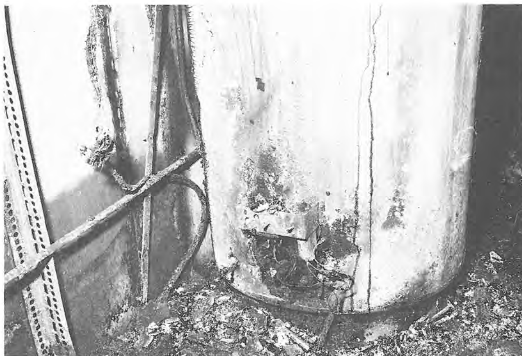
Figur 8 Nedre delen av vattenberedaren. Manövernredet till höger går till brytaren (helt uppbränd), och vredet till vänster går till termostaten vars ytterhölje finns kvar. Viss inbuckling på plåten på nedre delen av beredaren finns.
