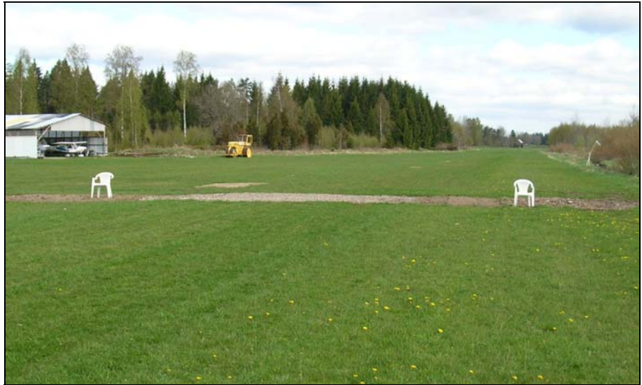
Markering av skada på bana 01
