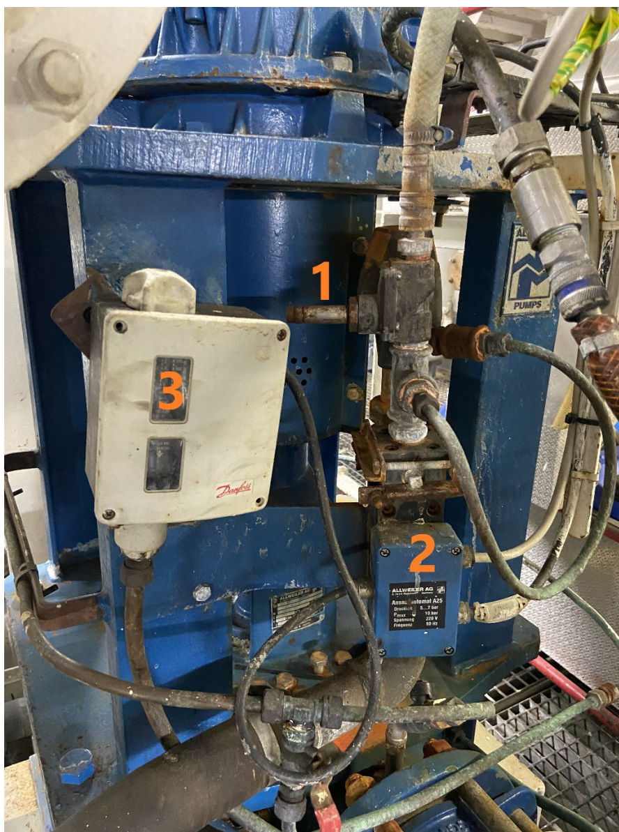
Figur 8. Barlastpumpen med ejektorn i förgrunden. 1: Magnetventilen där den strömförande spolen och kontakten suttit. 2: Kopplingsbox av metall, monterad på ejektorhuset av plast. 3: Tryckvakten som beroende på pumpens tryck startade och stoppade ejektorn.
