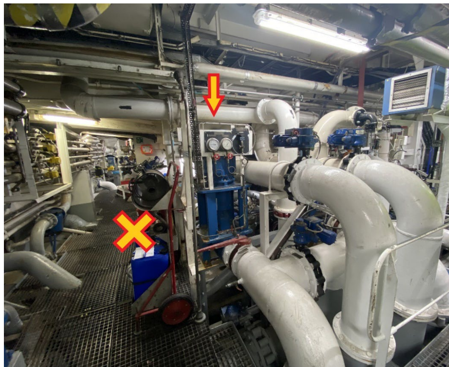
Figur 7. Pannrummet däck 1. Fartygsingenjören hittades vid det rödgula krysset och den rödgula pilen markerar barlastpumpen som kontrollerades.
