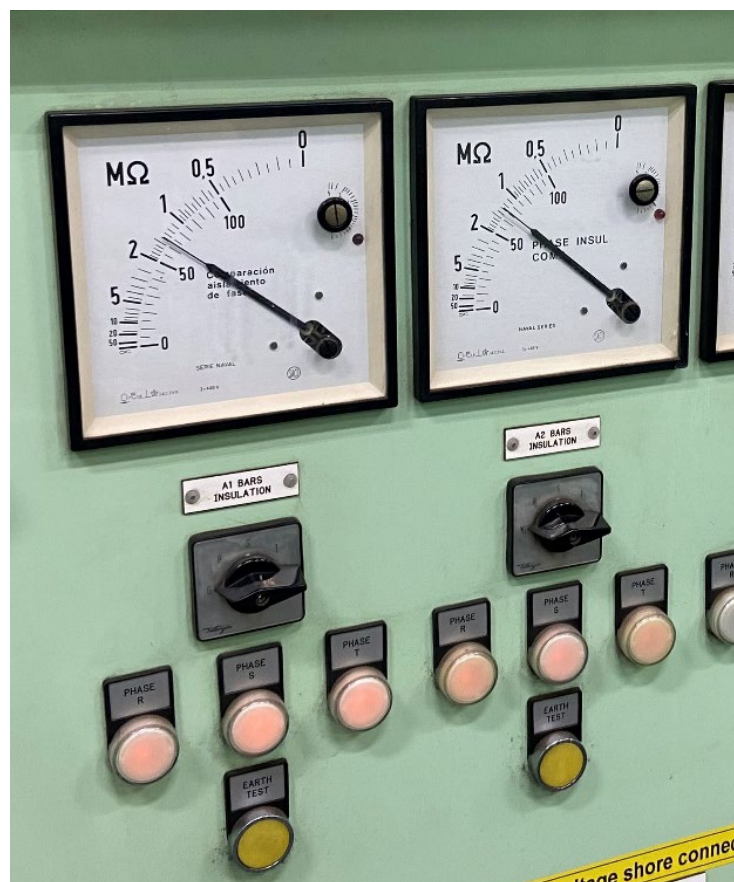
Figur 19. Isolationsmätningstrustningen ombord på STENA GERMANICA. Enligt instrumenten var isolationen vid fototillfället ca 1,4 megaohm, alltså högre än den miniminivå som rekommenderas i föreskrifternas allmänna råd.
