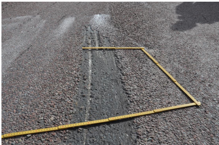
Figur 13. Skrap- och rivmärken i vägbanan ca 110 m från nollpositionen.
