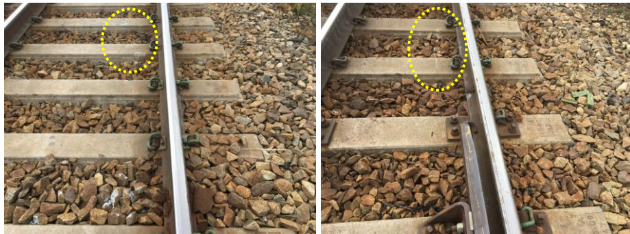
Figur 22. Märken på betongslipers före och efter korsningspartiet i växel 12. Foto: Trafikverket.
