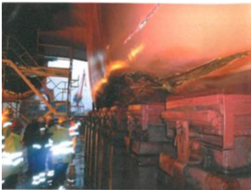
Figur 4. Område nr. 3: Från spant 9 till 19, börjar vid CL och gick ca 1 meter som bredast. Intryckningar i slaget ca 0,5 meter där skrovet hade penetrerats i form av en spricka in i torr tank nr 14. Skottet mellan torr tank 14 och styrmaskinsutrymmet hade skadats varvid vatteninträning även hade skett i styrmaskinsrummet. Foto: Destination Gotland
