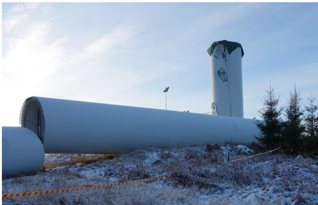
Figur 4. Skadorna på det segment som stod kvar.
