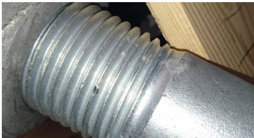
Figur 49. Skada på skruvens gänga.
