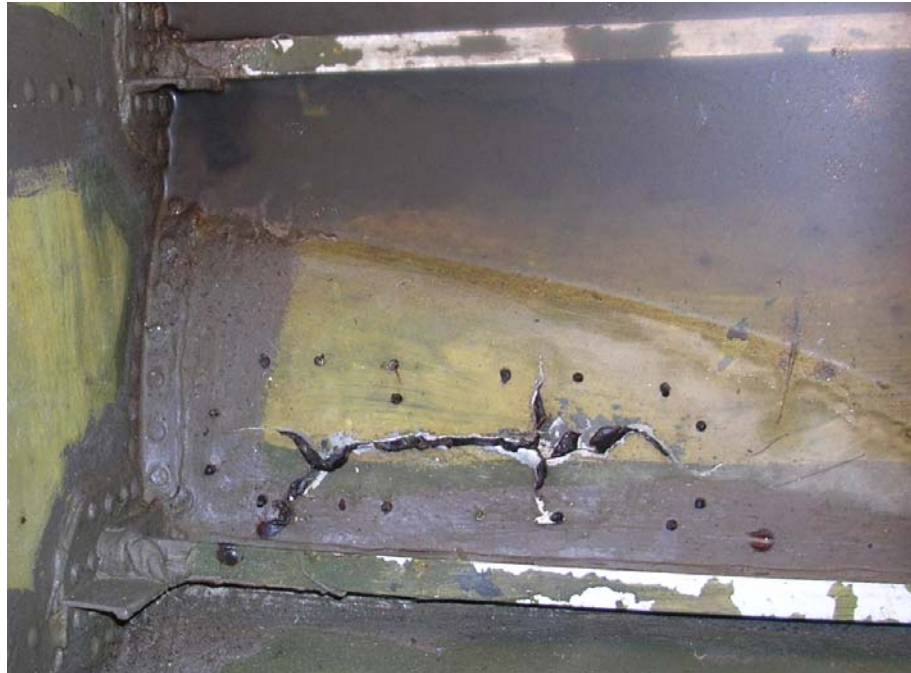
Flottörskada efter provisorisk reparation (sett inifrån)
