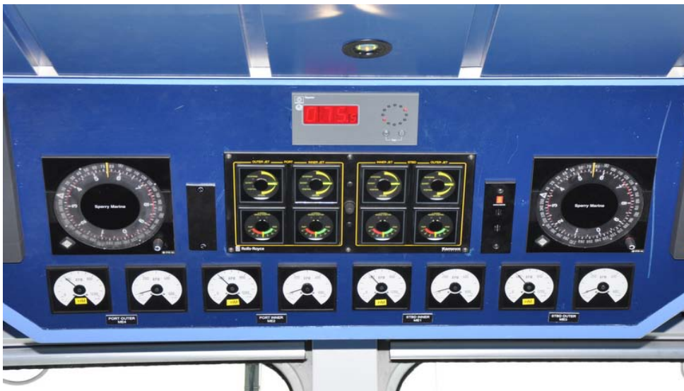
Figur 15 Instrumenten ovanför vindrutorna på Gotlandia II.
