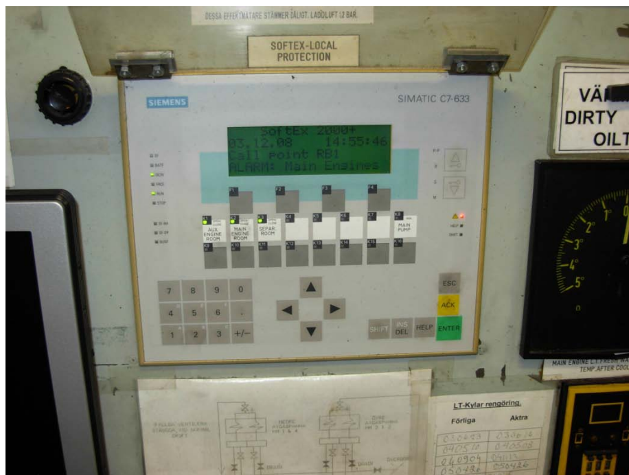
Figur 9 Manöverpanelen för utlösning av lokalt punktskydd belägen i kontrollrummet.
