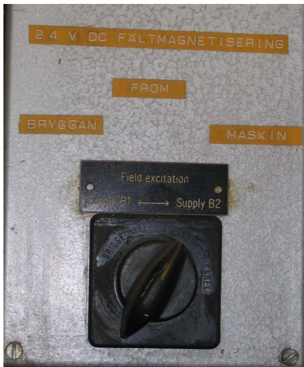
Figur 6 Omkopplare för likspänning till fältmagnetisering, placerad i kontrollrummet.
