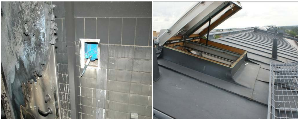
Fig. 21a-b Öppningsanordningen med vev för rökluckan placerad bakom brandlägenhetens entrédörr samt rökluckan sedd från taket med vajer och handtag för utvändig öppning.
