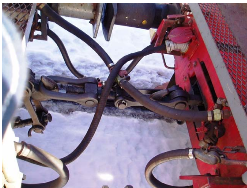
Fig 11. Avstängningsventiler (kikar) och slangar mellan loken.
