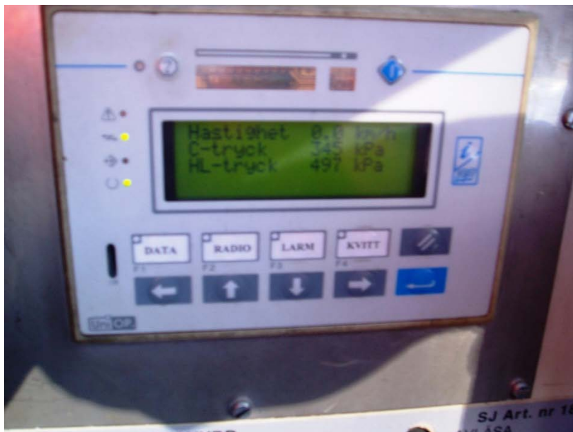
Fig 19. Radiostyrningens display i hytten på lok T44 346 (lok som gick närmast vagnar), visande tryck vid nödbroms från lok T44 286 (det lok som gick först).
