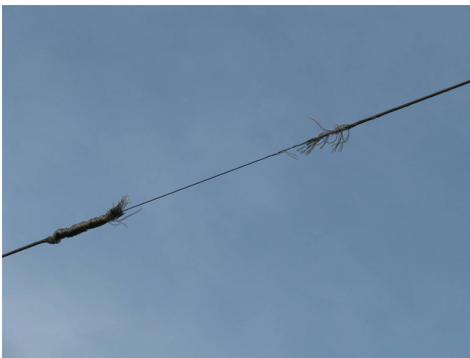
Bild 3 Skador på kraftledning. (Foto SHK)
