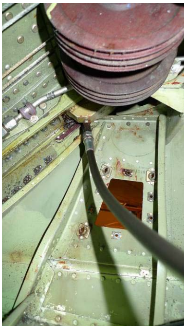
Fig. 9 Smörjning av stabilisatorgångjärn (Stabilisator Hinge) via panel 6309A
