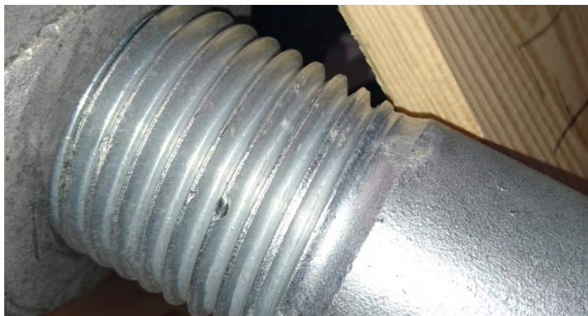
Figur 49. Skada på skruvens gänga.
