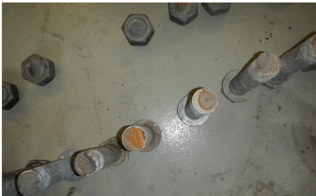
Figur 14. Bild på tornskruvarna med utmattningsbrott och varierande grad av restbrott.
