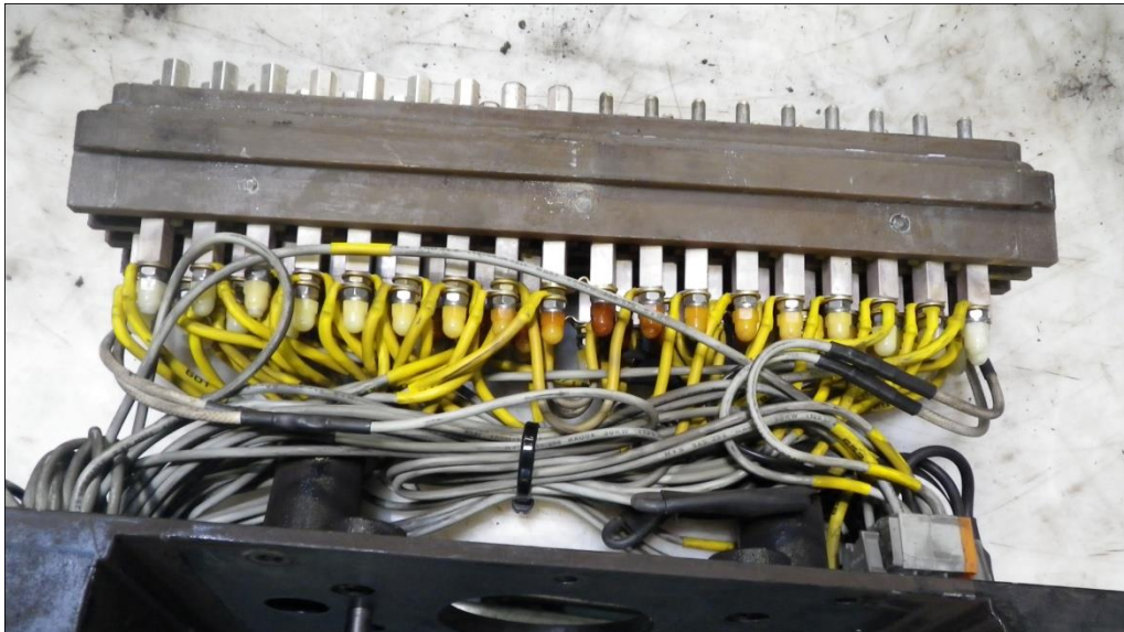
Figur 7. Lågeffektdonets kontaktblock med dess kabelanslutningar.
