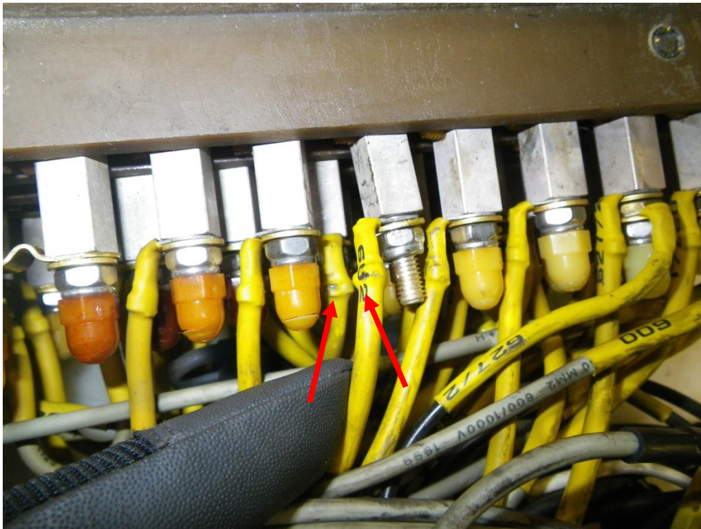
Figur 8. Skadad isolering på kabelskor till kontakt 6 och 16.
