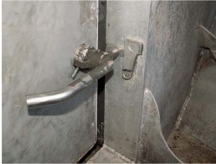
Fig. 17 Understa karmvredet i felaktigt "skalkad" position med dörren på glänt. Låstappen läser mot dörrkarmen där det finns avtryck från tappen.
