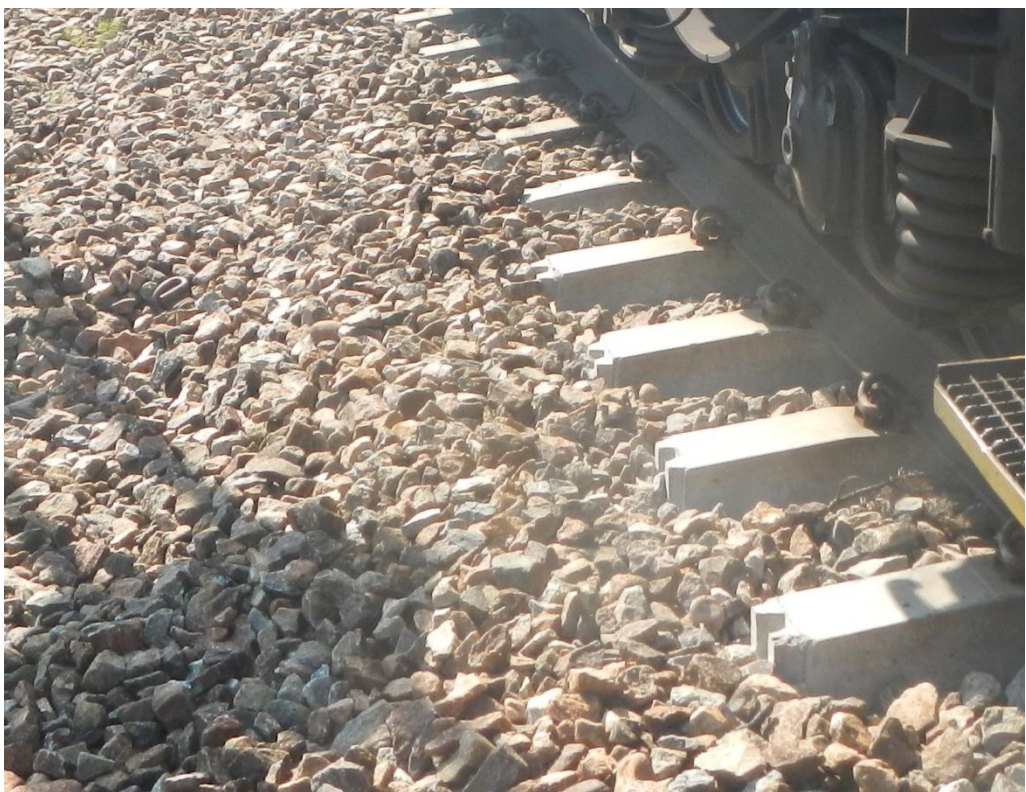
Figur 3. Nedspårets utsida på platsen där sidoförskjutning skett.
