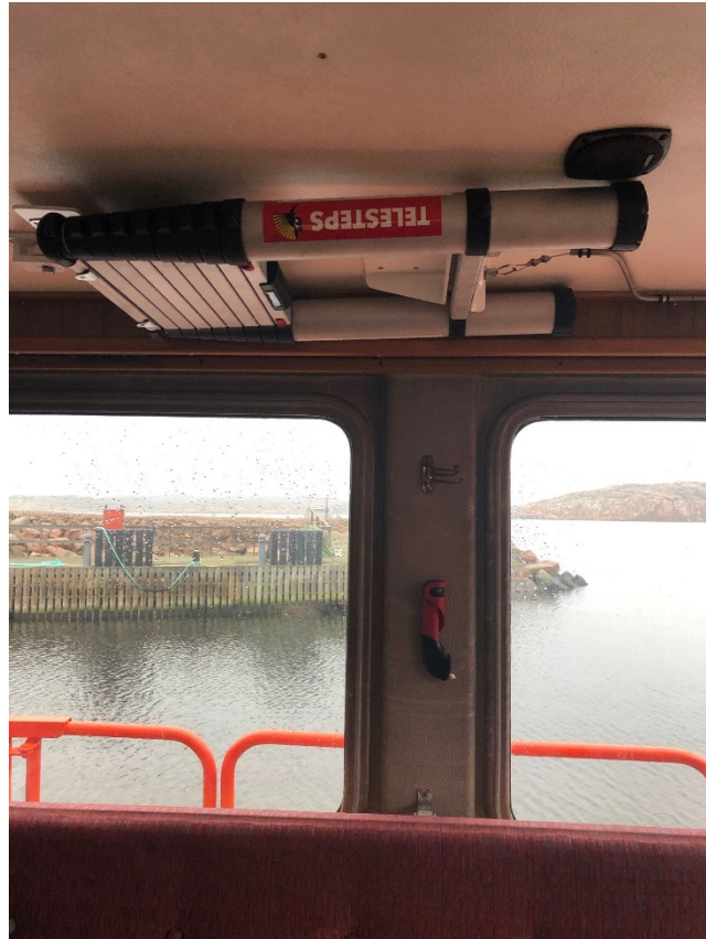
Figur 12. Nyinstallerade stegar i taket och nödhammare placerade mellan fönstren. Bild: Sjöfartsverket.
