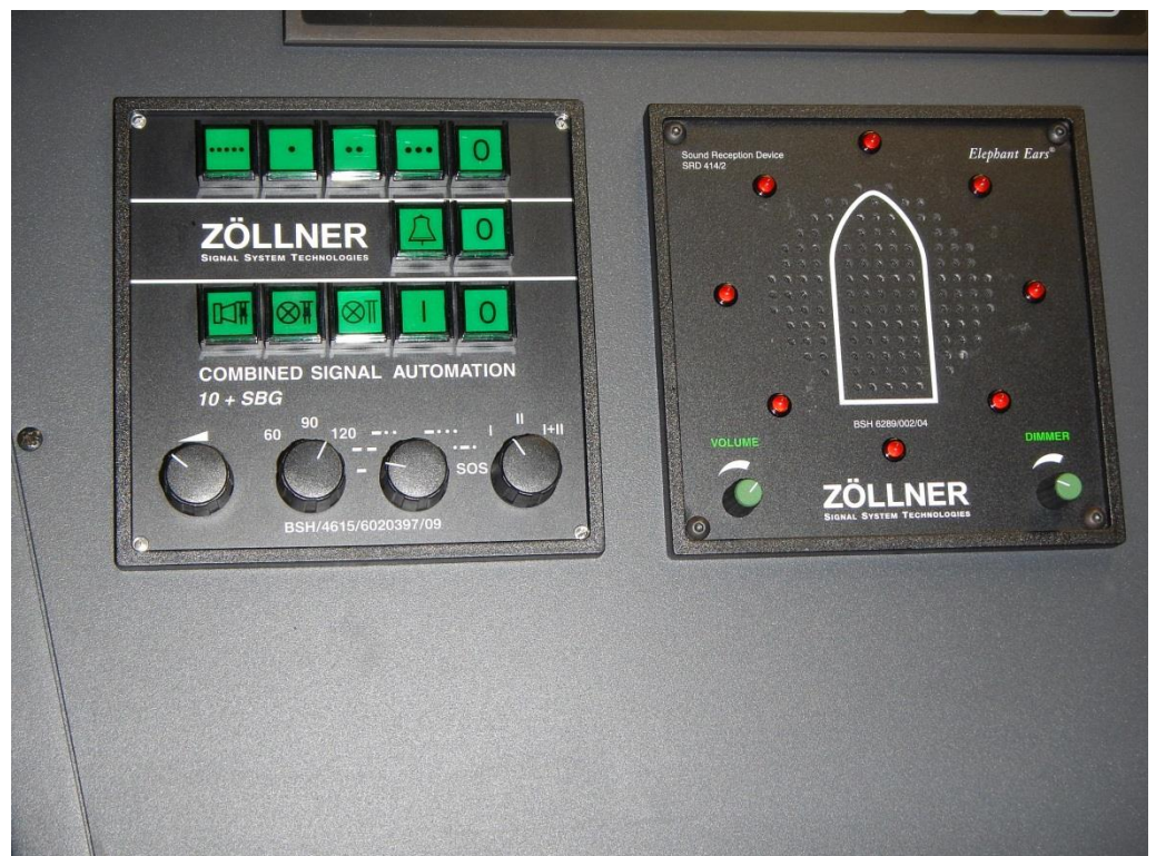
Figur 11. Till vänster ses panelen för den automatiska mistsignaleringen, till höger det s.k. elefantörat. De röda lamporna runt fartygskonturen indikerar från vilket håll ljudet kommer.
