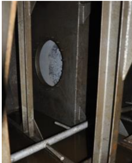
Figur 21. Manhål mellan styrbords och babords centrumutrymmen.
