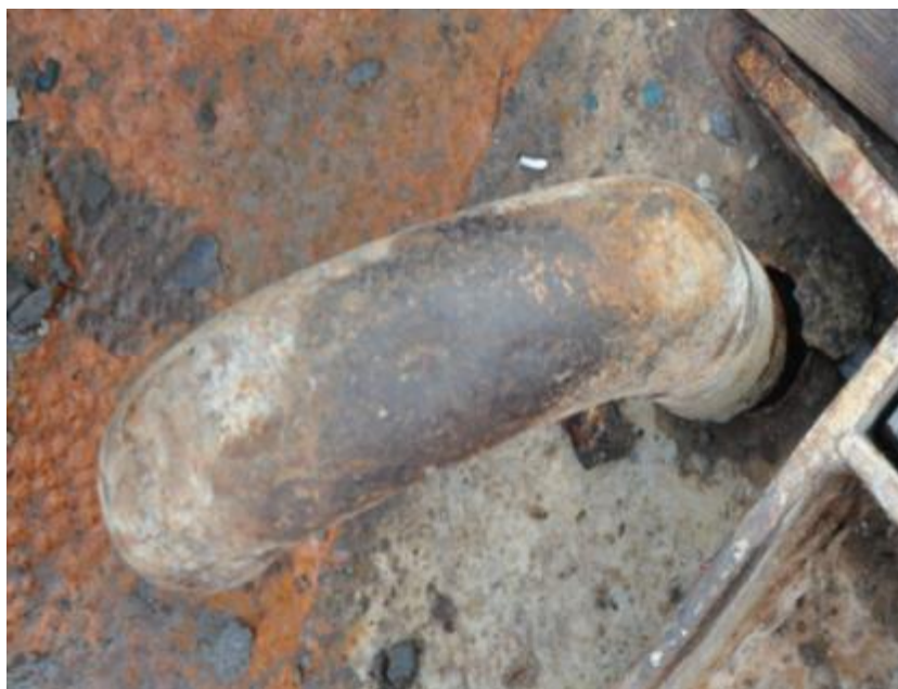
Figur 16. Avrostat luftrör till det förliga utrymmet på styrbordssidan. Rostskadorna syns tydligt där röret går ner i däckets (i mitten till höger i bild).
