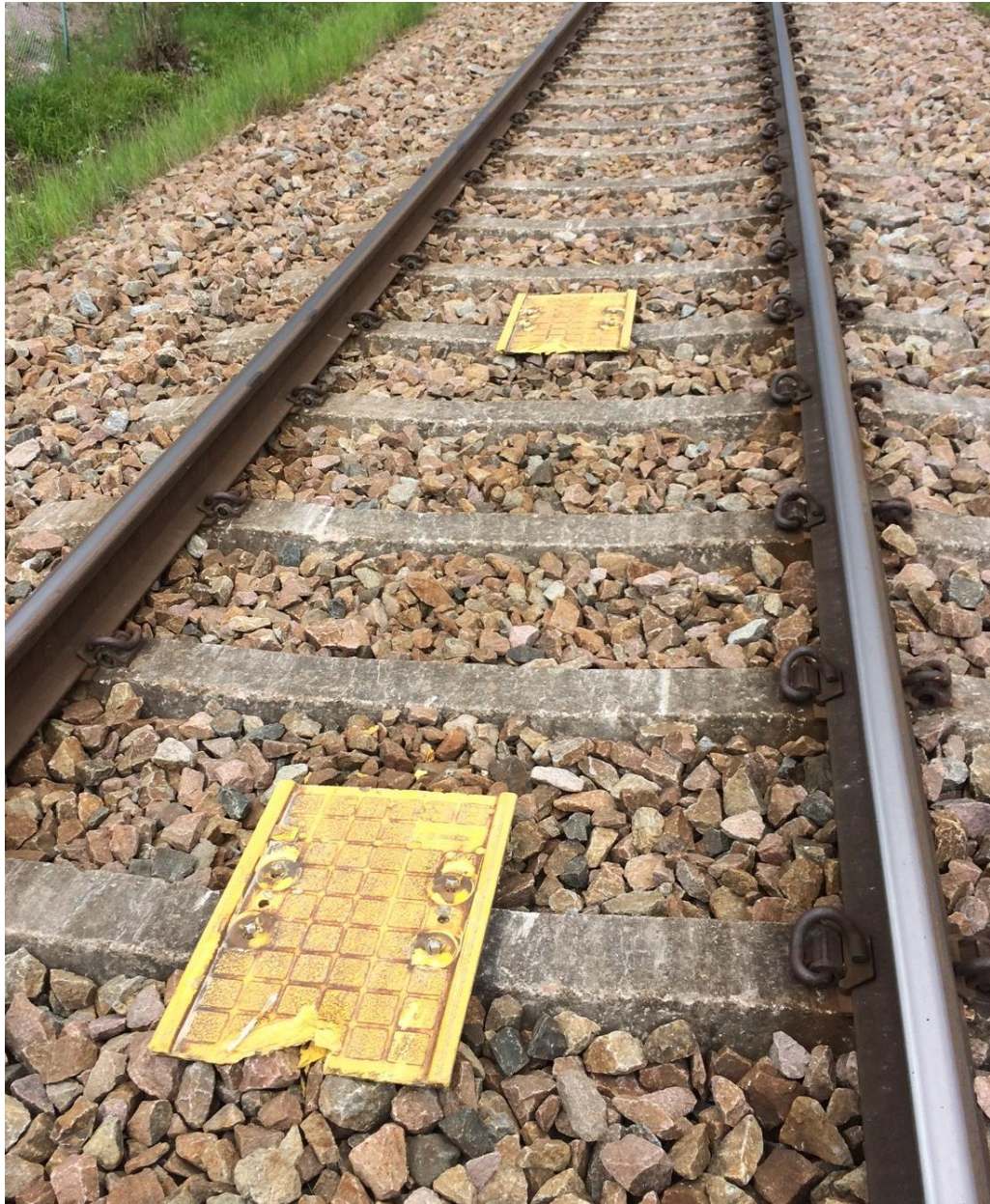
Figur 5. De skadade baliserna i spåret. Foto: Strukton Rail AB.
