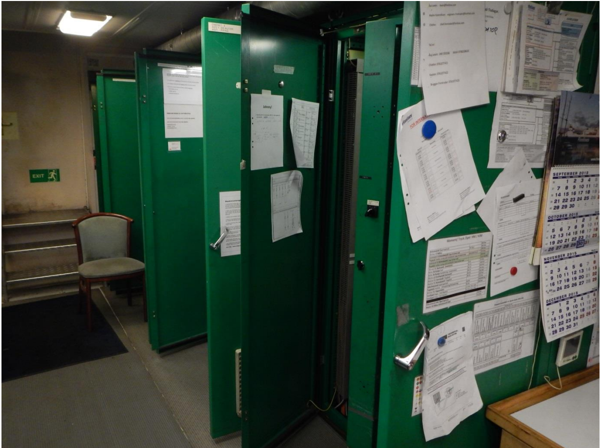
Fig. 4. Skåpen där datorerna till maskinkontrollsystemet förvaras.
