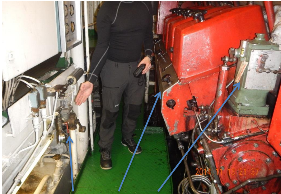
Figur 7. Avstängningsventilen. Skyddskåpa. Regulatorn.
