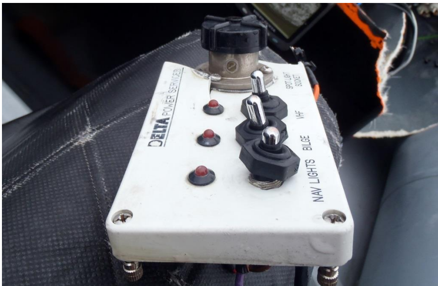
Fig. 11. Brytarpanelen för bl.a. lanternor med brytaren i frånslaget läge.
