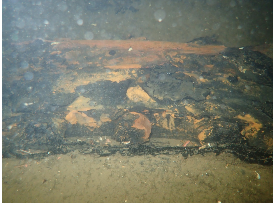
Figur 11. Vattenledningens bultförband vid en skarv samt omgivande intryckningsskada i röret. Bild: Stockholm Vatten.
