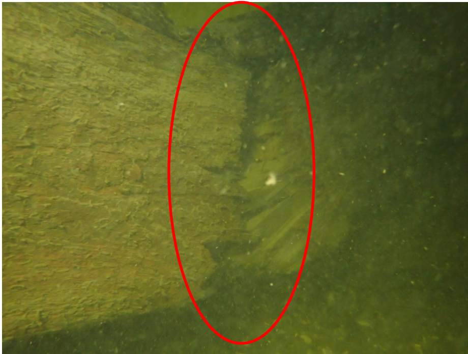
Figur 10. En av de tre brustna tvärslåarna i stödkonstruktionen. Bild: Stockholm Vatten.
