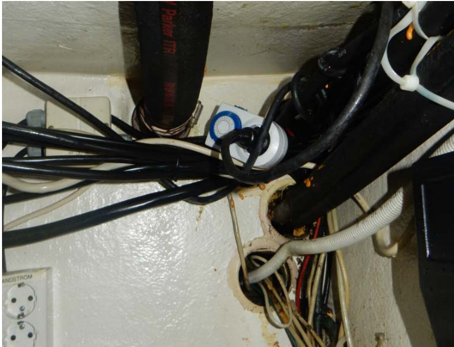
Figur 9. Skott mellan maskinrum och lastrum, sett från maskinrummet. Här syns tydligt genomföringar för kablage och slangar.
