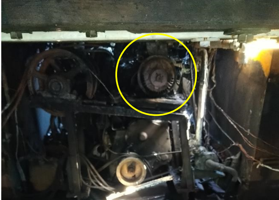
Figur 14. Remtransmissionen i framkant på motorn. Den gula ringen markerar generatorm vars axel inte gick att rotera.
