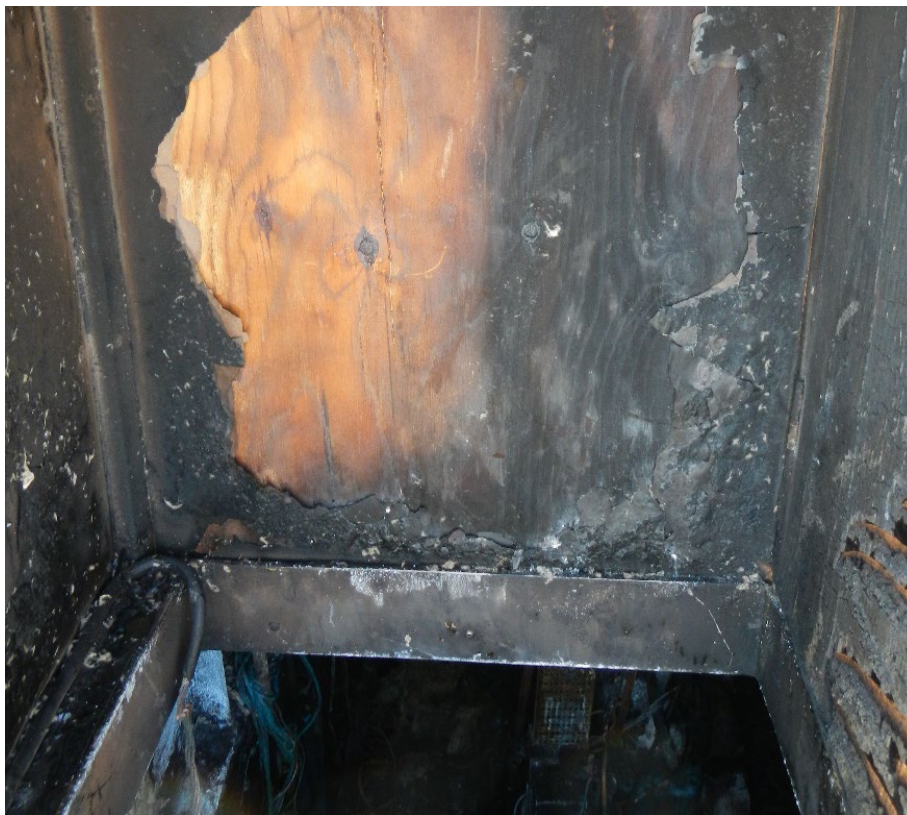
Figur 10. Nedgången till motorrummet. Endast ytskiktet på träfiberskivorna har brunnit.
