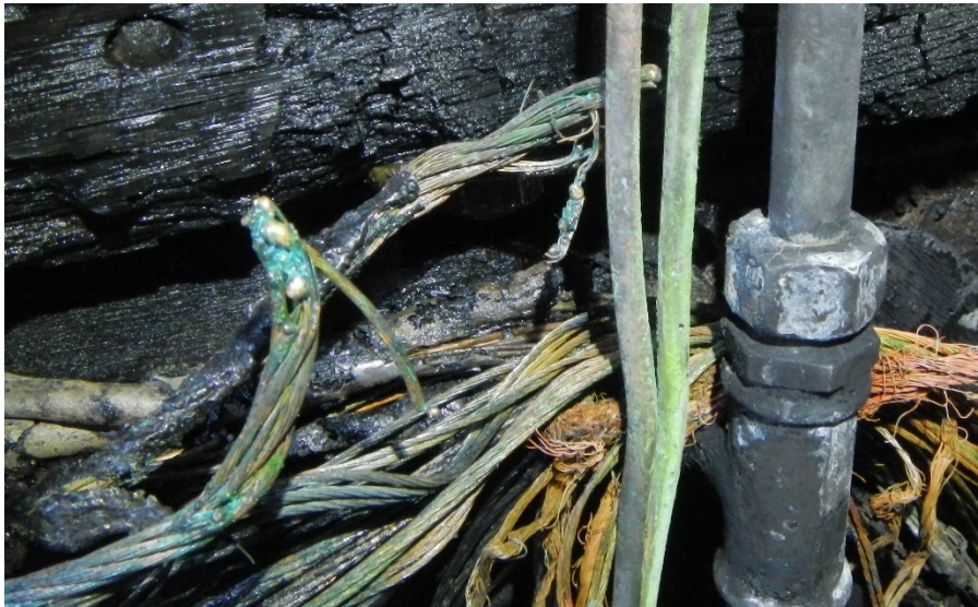
Figur 13. Avsmälta kabeländar ca 70 centimeter ovanför batterierna.
