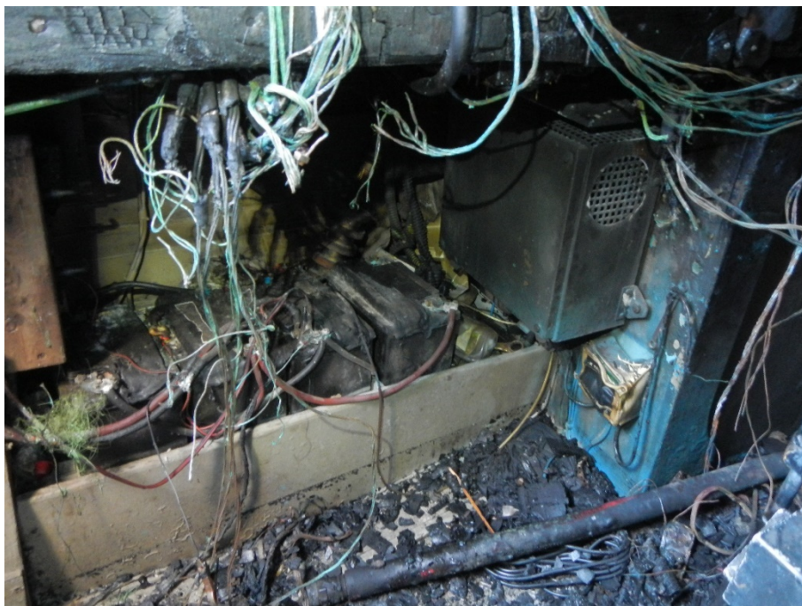
Figur 12. Stuvutrymmet på babords sida där bland annat batterierna stod.
