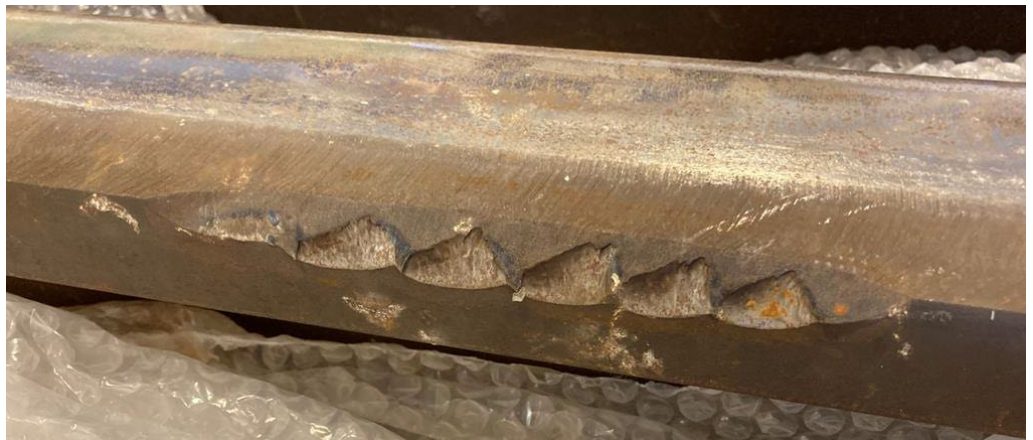
Figur 21. Mekanisk skada på kanten av farbanan mellan brottyta 8.2 och 9.1
