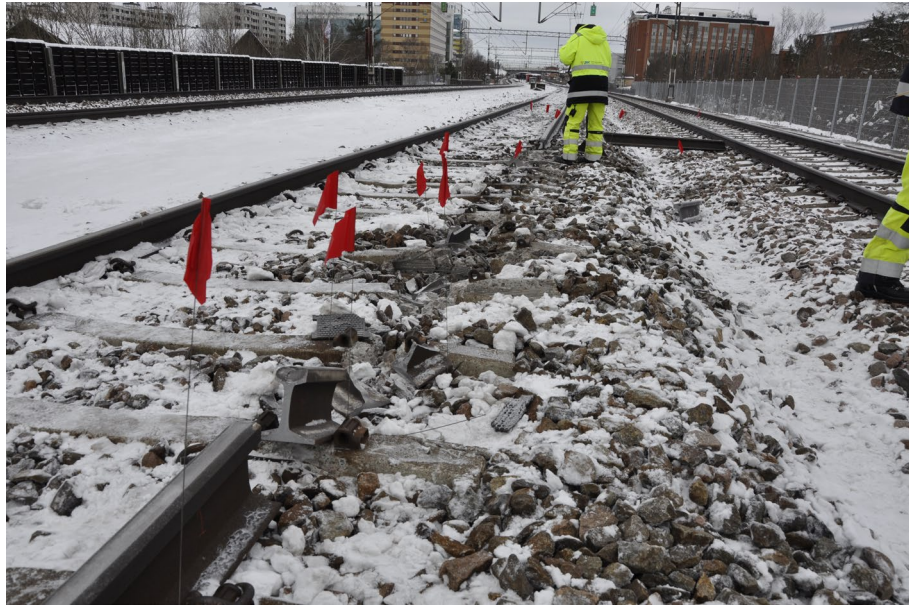
Figur 5. Rälsbrott söder om Sollentuna pendeltågsstation (stationen ligger i höjd med höghusen i bakgrunden).
