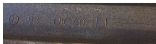
Figur 15. Registerutdrag från Trafikverket och märkning på rälen visar att rälen är av modell UIC 60, stålsort R260, tillverkad i Luleå.
