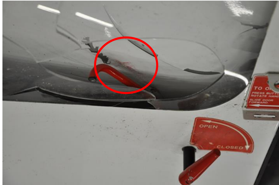
Figur 53. Bilden visar ett slagmärke på skrovsidan från det inre dörrhandtaget.
