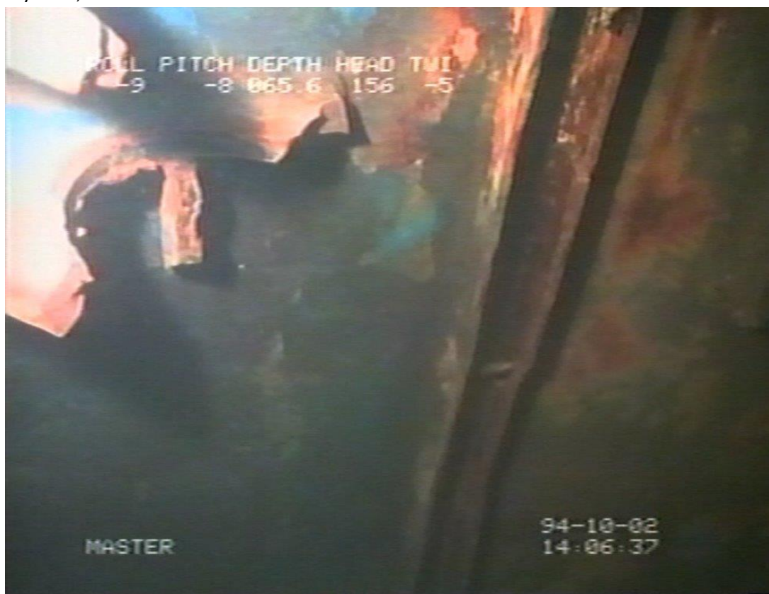
Fig. 1.6. Bilden visar en skruv som skulle hålla packningen på plats, samt avsaknad av visirets packning. Bilden är från filmmaterial inspelat i oktober 1994.
