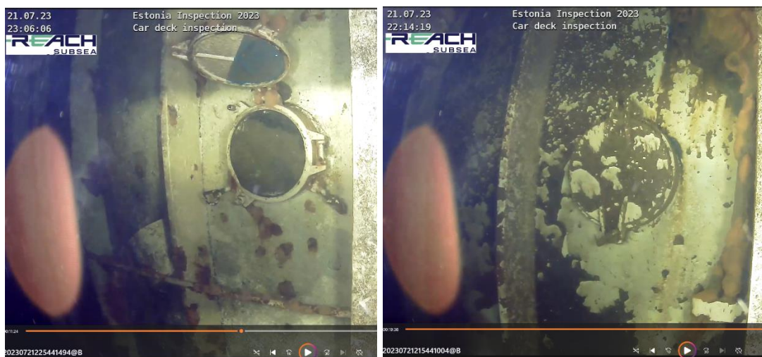
Fig. 2.1. Bilder från filmningen sommaren 2023. Vänster visar en ventil på däck 2 där stormluckan inte är nerfälld, och höger visar en nedfälld och skalkad stormlucka på däck 3.
