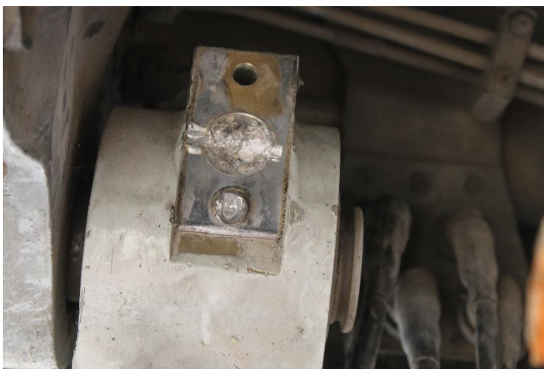
Fotografía No. 12 Soporte del actuador del tren derecho dañado.
