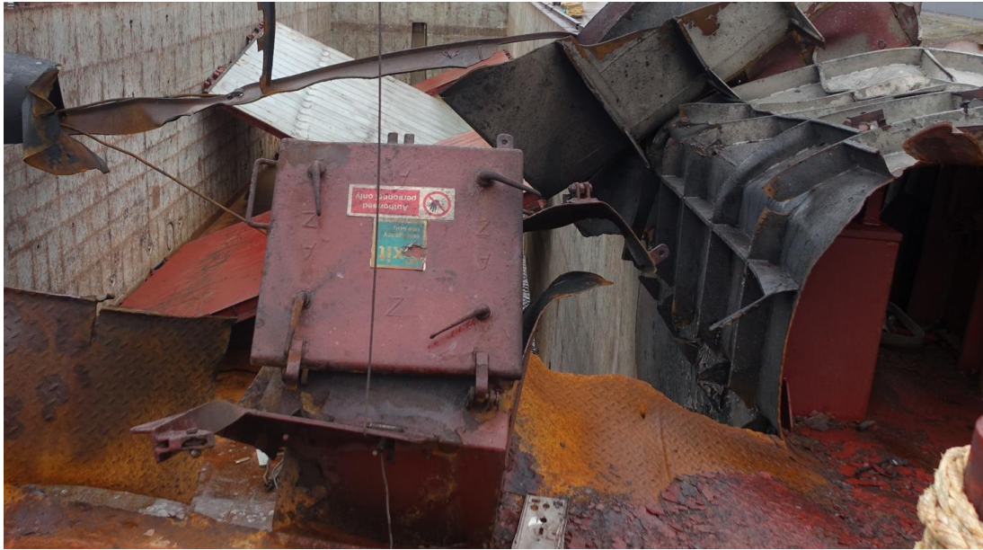
Figur 12. Nedgångsluckan till utrymmet där gasolflaskorna förvarades. Varningsskyltar för brännbara gaser kunde inte ses.
