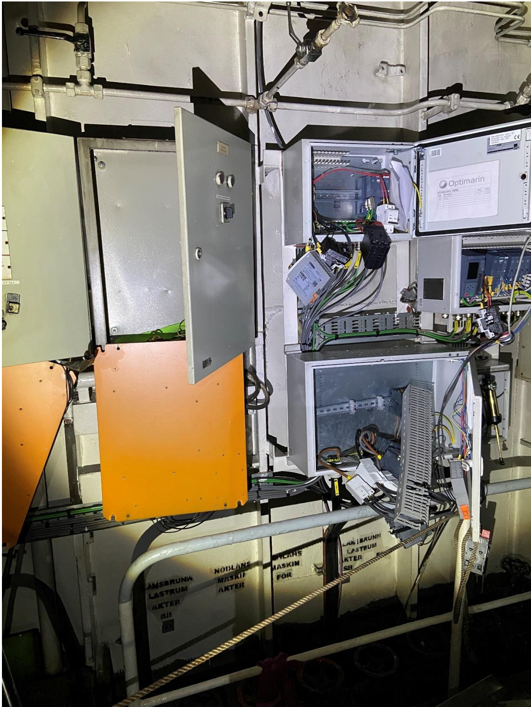
Figur 11. Det förliga skottet i maskinrummet som också är det aktra skottet i lastrummet. Elskåpen skadades av tryckvågen. Dörrarna hade öppnats och komponenterna lossnat av tryckstöten från explosionen.
