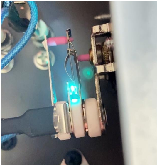
Figur 15. Ljusbågen som uppstod i värmefläkten när termostaten slog till eller från under försöken med en liknande värmefläkt.
