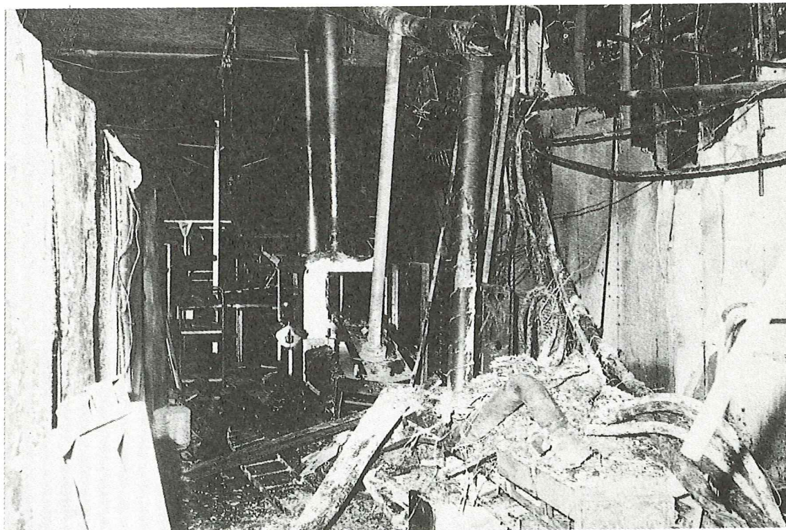
Figur 3 Bilden visar de brandskadade ventilationskanalerna till processventilationen för löd- och tvättmaskinerna
