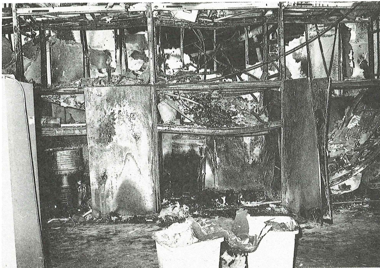
Figur 10 De tre norra plåtskåpen. I det högra skåpet syns två liggande plåtfat. Det ena av dessa har sprängts vid branden. I mellanskåpet står ett plåtfat, medan två plåtfat står i vänstra skåpet – ett av dessa syns ej på bilden, eftersom det står bakom dörren.
