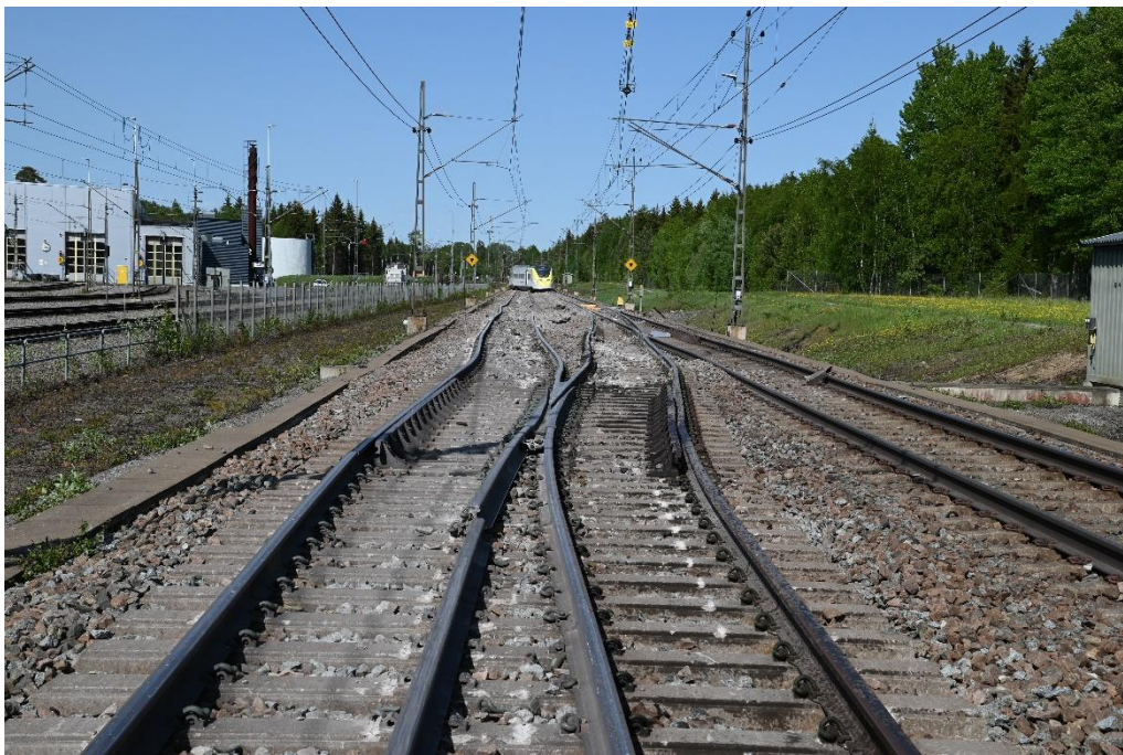
Bilden visar skadorna i växel 102 mot det urspårade tåget i bakgrunden.
