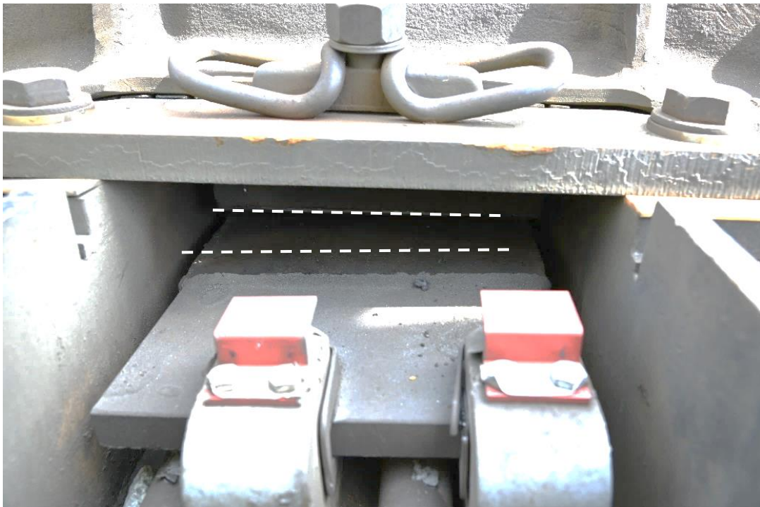
Bilden visar bottenplåten i drivanslutningsplattan som lossnat från vinklarna upp till korsningsspetsen. En av de brustna svetsfogarna framgår där den övre och nedre delen är markerade med vita streckade linjer. Drag- och kontrollstängerna från växeldrivet är synliga i bildens nederkant.
