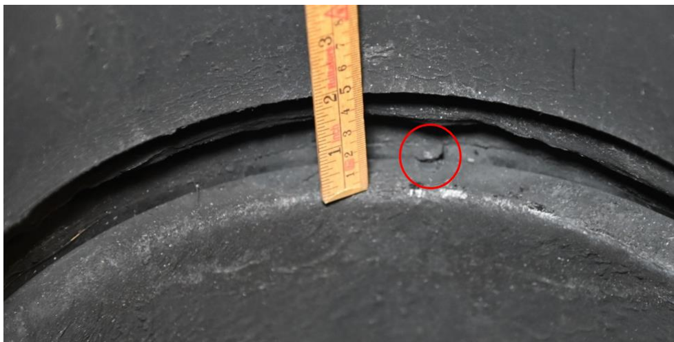
Figur 19. Skarven på insidan av elmuffen med ett avstånd på ca 45 mm mellan rören. Den röda markeringen visar stopplacken. I ovankanten av skarven syns smält plast som tryckts ut.
