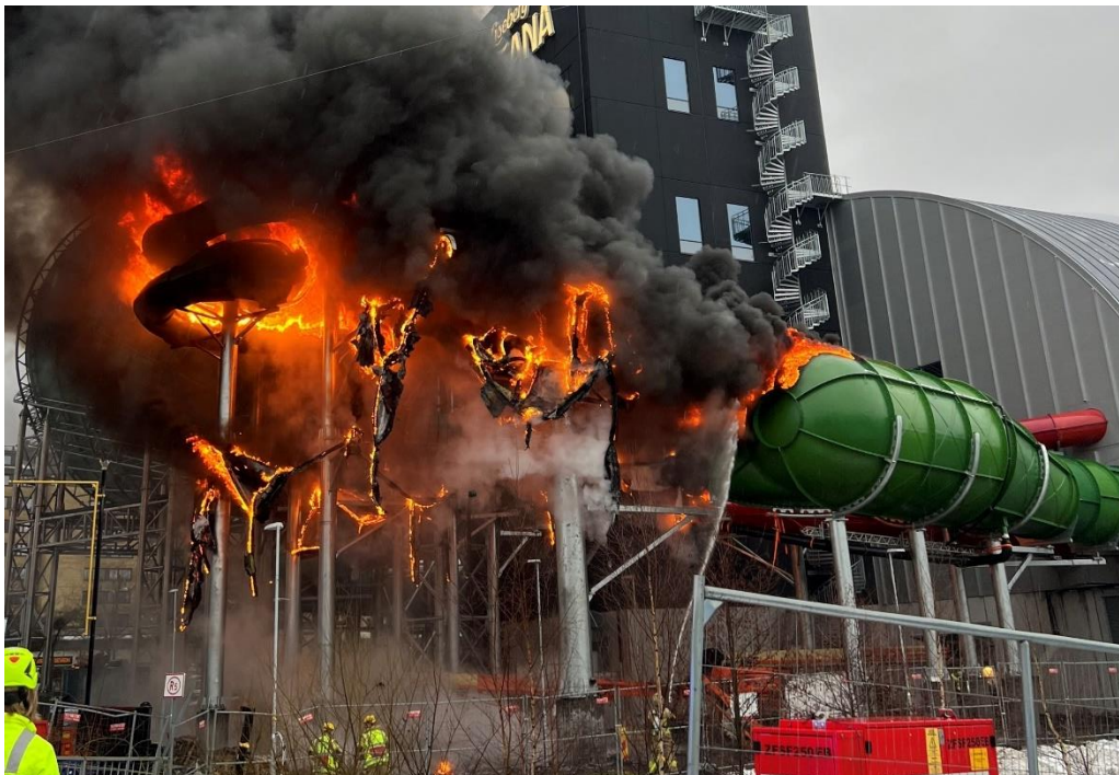
Figur 8. Släckningsarbete pågår. Foto från kl. 10.16. Foto: EnviroProcess Sweden AB.
