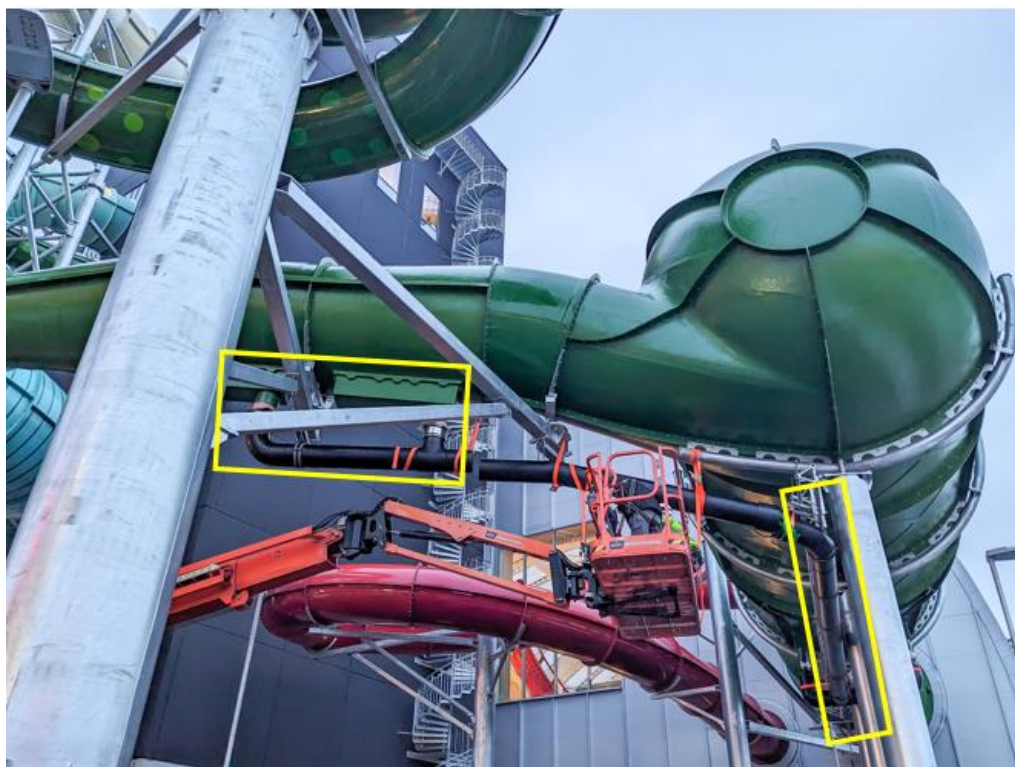
Figur 11. De gula rutorna tillförda av SHK visar till vänster ett PE-rör anslutet till dräneringsboxar och till höger ett PE-rör som ansluter tillbaka till Rattler. Mellan markeringarna syns ett upphängt rör i spännband förberett för att svetsas ihop med övriga rör. Foto: NCC.
