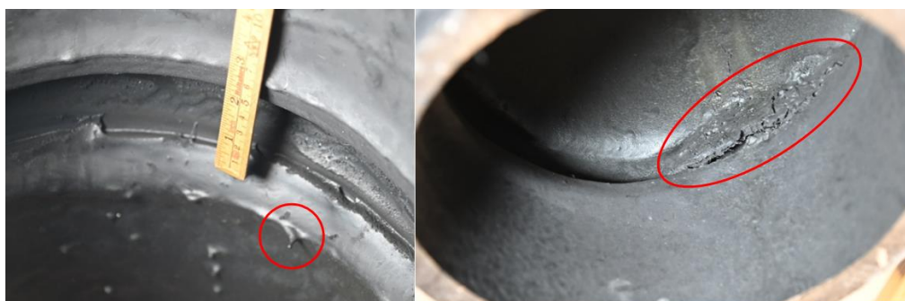
Figur 20. Vänstra bilden visar ovansidan på skarven i den rördel där droppformationer fanns. Den röda markeringen visar droppformen efter smält plast som runnit ned. På högra bilden syns motstående sida från droppformationerna i skarven. I den röda markeringen syns de förkolnade resterna där plasten sannolikt brunnit.
