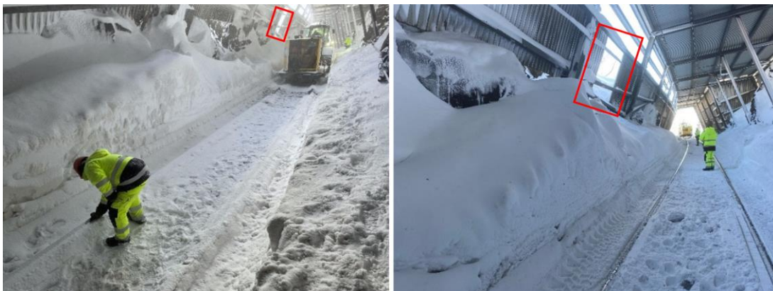
Figur 20 visar två bilder från snögalleri 14 i tågets färdriktning. Efter den maskinella snöröjningen framgår snödjupet och profilen på snön fram mot den saknade plåten i väggen.
