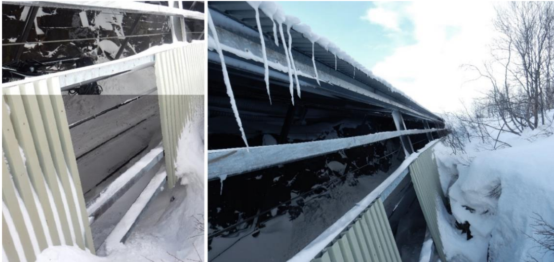
Figur 18 visar till vänster en sammanfogad bild utanför den saknade plåten. Spåret innanför hade då röjts från snö. Till höger området parallellt med den saknade plåten i riktning västerut och mot bergsskärningen.
