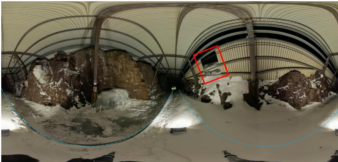
Figur 26 visar en bild västerut inne i snögalleri 14 i 360 graders perspektiv. Den saknade plåten i väggen är markerad med röd ram. SHK har tillfört de blå streckade linjerna som visar var höger och vänster räl ligger i bilden. Det framgår att den högra rälen, som var den vänstra i tågets färdriktning, vid fotograferingen var täckt av snö. Foto: Trafikverket.
