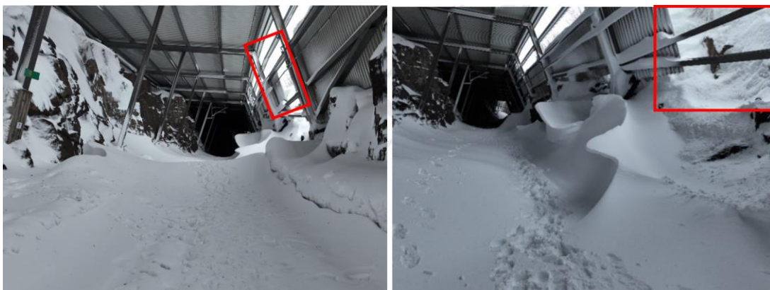
Figur 17 visar drivbildningen vid den saknade plåten (markerad med röd ram). Till vänster vid km 1536+040 och till höger vid km 1536+050.
