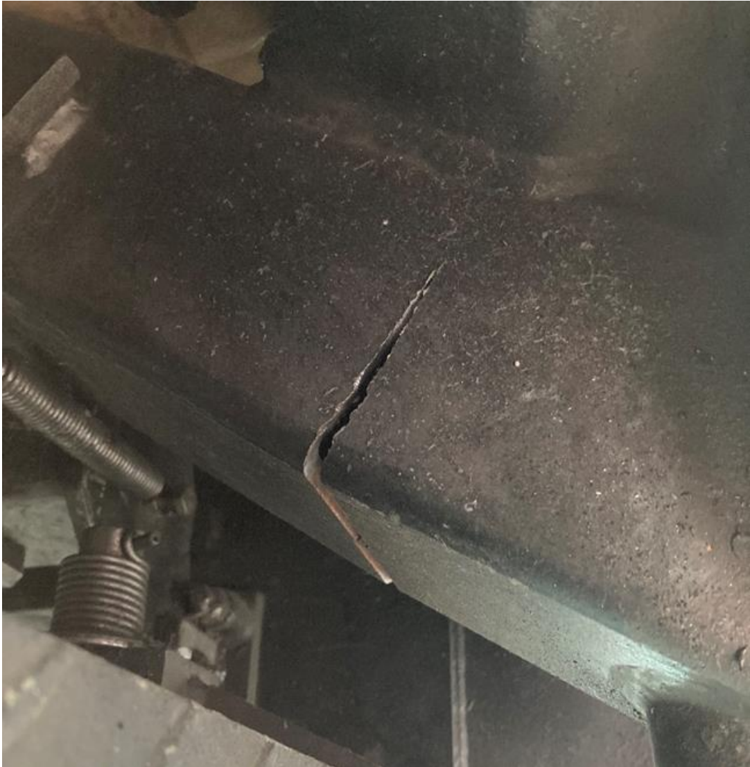
Figur 27. Sprickan som upptäcktes 28 augusti 2022 i en ursprunglig bakre bärram från 1988. Foto: Gröna Lund AB.
