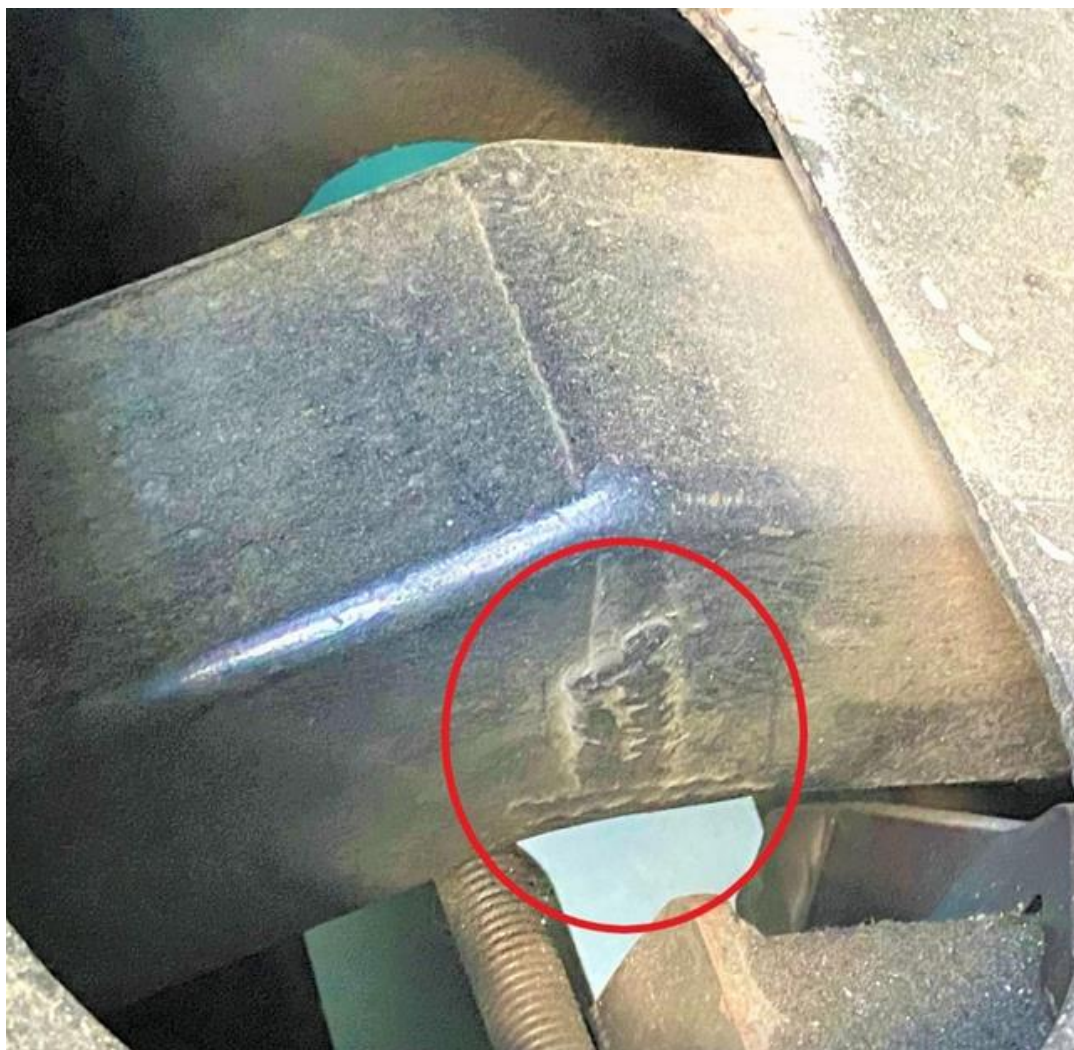
Figur 29. Svetsreparation på en bärmarm markerad med röd ring. Fotot är taget på en bärmarm monterad i C-tåget. Svetsreparationen är på svetsen mellan bärmarmens ytter- och mittdel.
