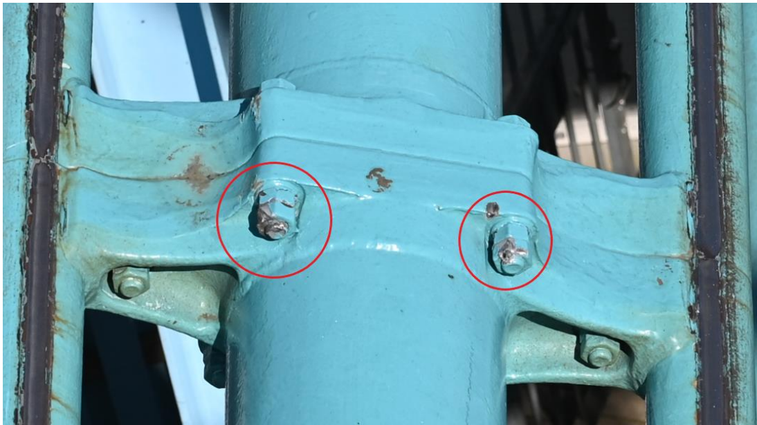
Figur 12. De kraftigare islagsskador på skarvarnas skruvförband syns inom de röda cirklarna.
