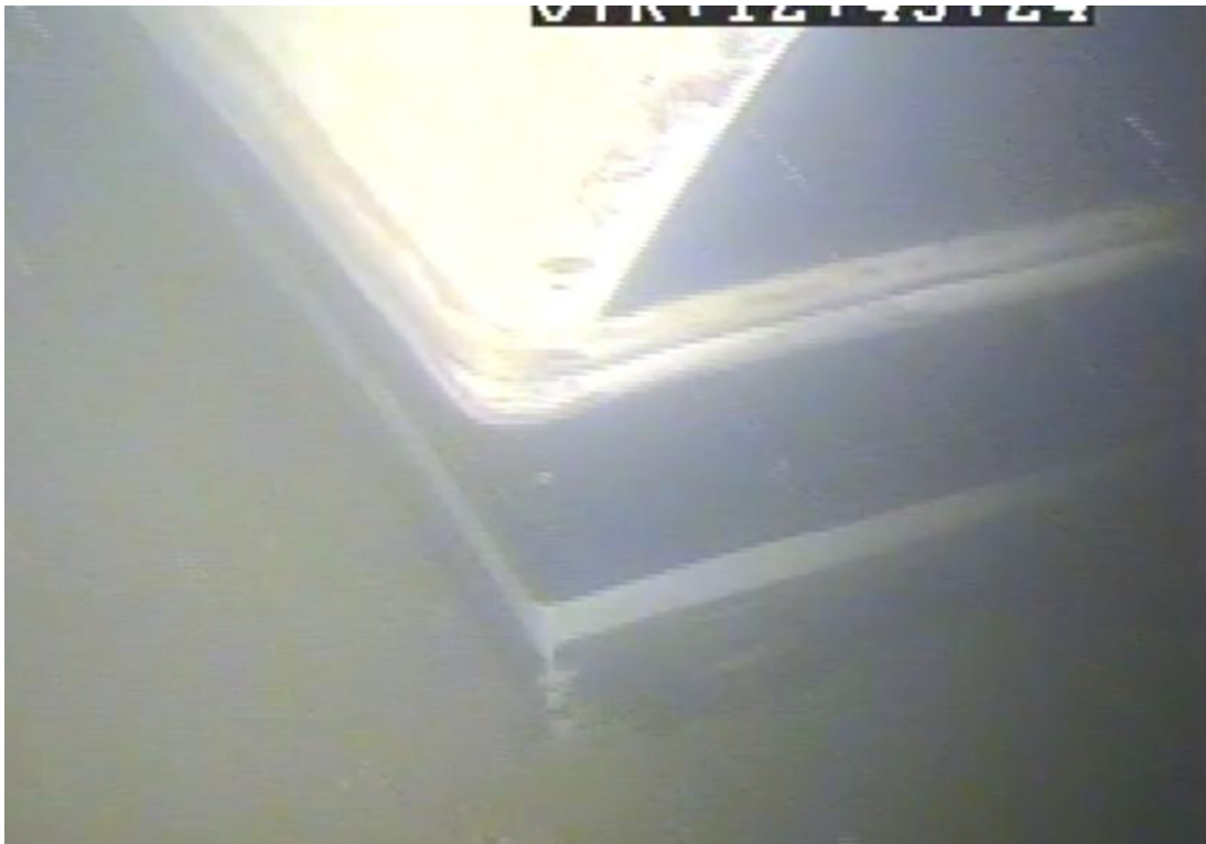
Figur 7. Styrbords aktra hörn på HAJEN. Fartyget har sjunkit ner till den normala vattenlinjen (vit rand). Bild från Kustbevakningen.
