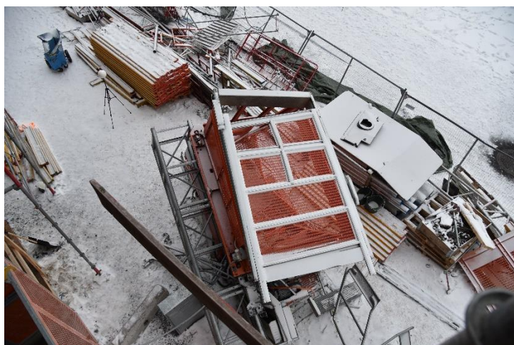
Figur 5. Den skadade hisskorgen med de delar som följde med i fallet.
