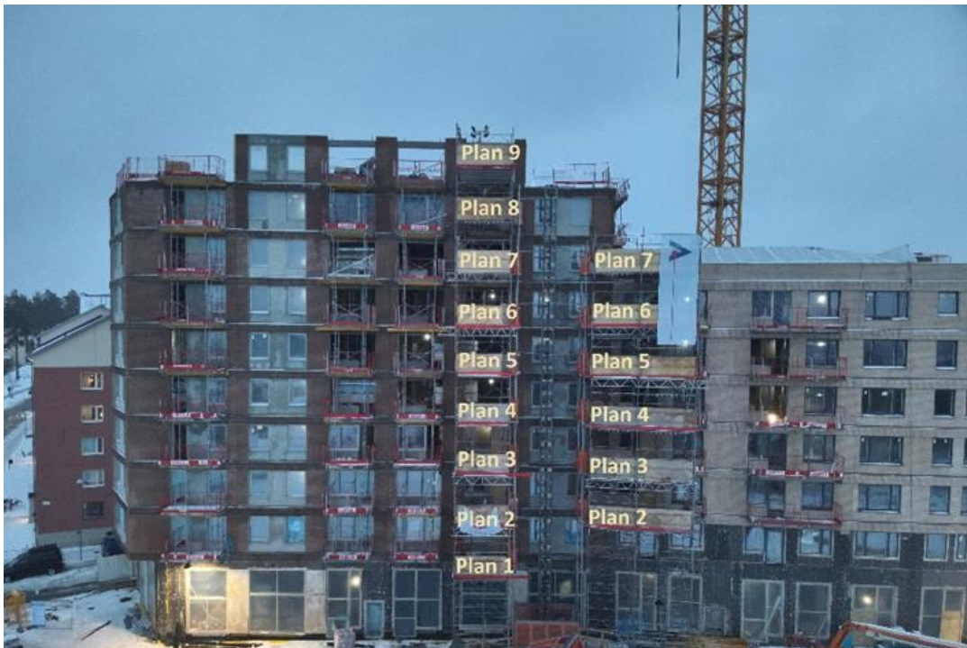
Figur 2. Huset efter olyckan. Bilden är från den 11 december 2023. På bilden framgår den numrering av våningsplanen som SHK använder i rapporten.
