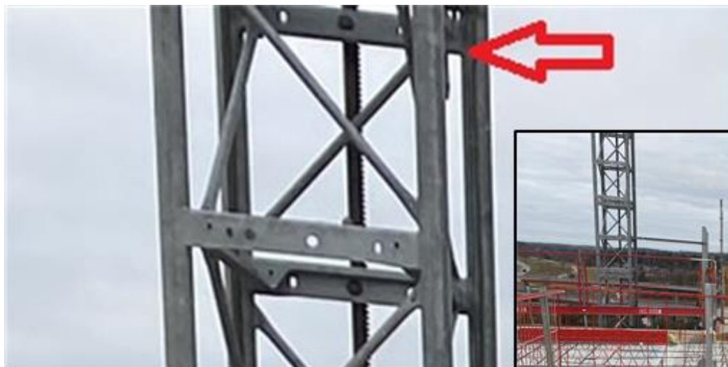
Figur 19. Bild från den 14 november- På bilden syns att det saknas ett skruvförband mellan mastsektion 19 och 20, se markering med pil. Bilden är beskuren och inzoomad av SHK. Bild: Andersson Company Byggnads AB. SHK har infogat markering i rött.
