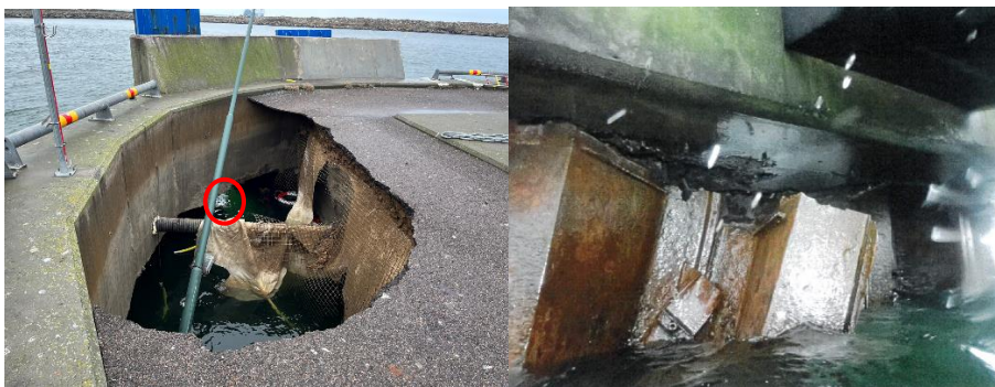
Figur 7. Skador på pir. Vänster bild: hål i pirens ytbeläggning, avsaknad av fyllnadsmassor samt hål i spontvägg (inringat med rött). Höger bild: deformerad stålspont längs vägg, krönbalk och fenderfäste synligt i övre delen av bilden. Bilder: Copenhagen Malmö Port, CMP. Markering i form av den röda cirkeln infogad av SHK.
